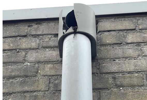
beschadiging van de HWA
