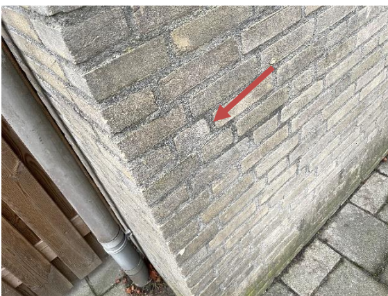
incidentele constructieve scheuren
