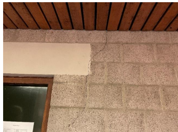
beschadiging ter plaatsen van betonnen latei
