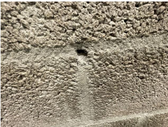
beschadiging binnenmuur gymzaal 4
