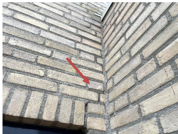
scheur in de gevel
