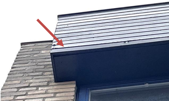
beschadiging houten regelwerk
