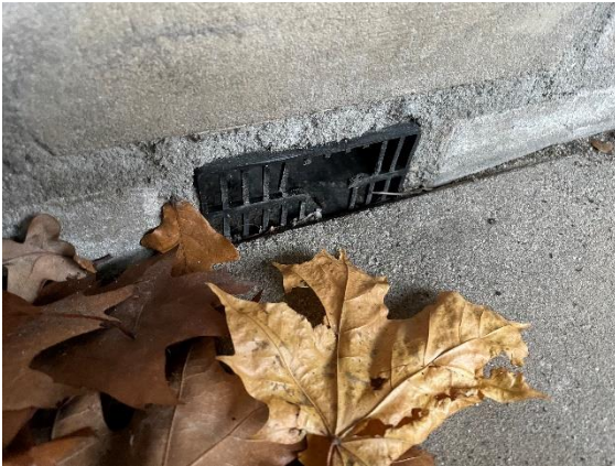
beschadiging ventilatierooster kruipruimte
