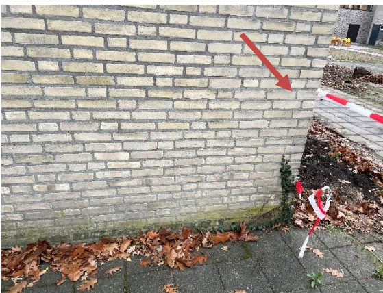
scheurvorming wegens het ontbreken van dilatatie
