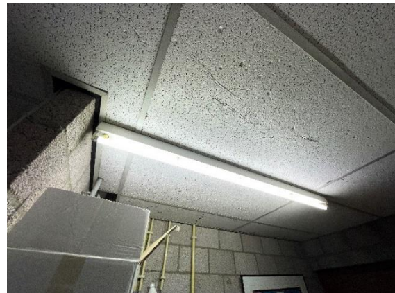
Beschadiging plafondplaten kleedruimten
