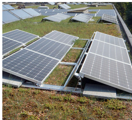
Groen dak met zonnepanelen
