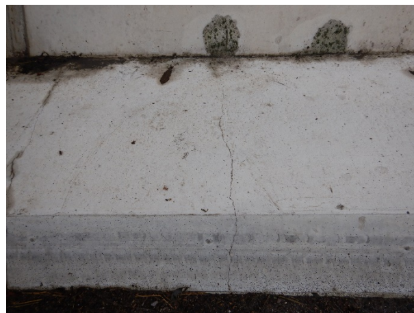
Figuur 4.23: Scheuren in de schampstrook
