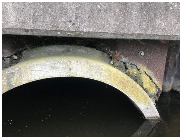
Figuur 4.2: Corrosie stalen bouwdeel 411
