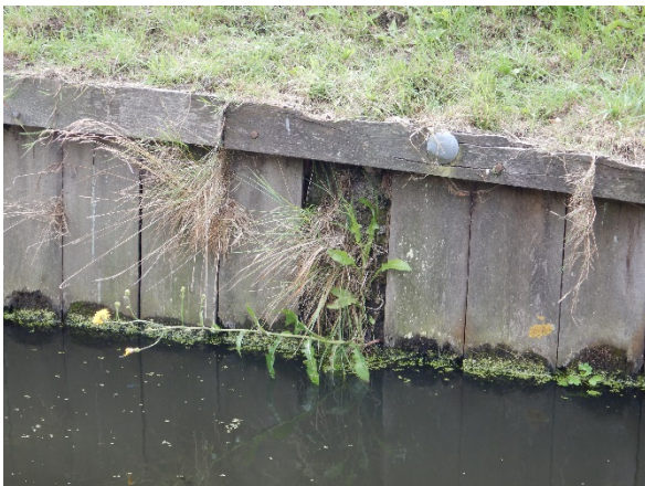
Figuur 4.18: K371, plank is weg en damwand in doorgerot op waterlijn
