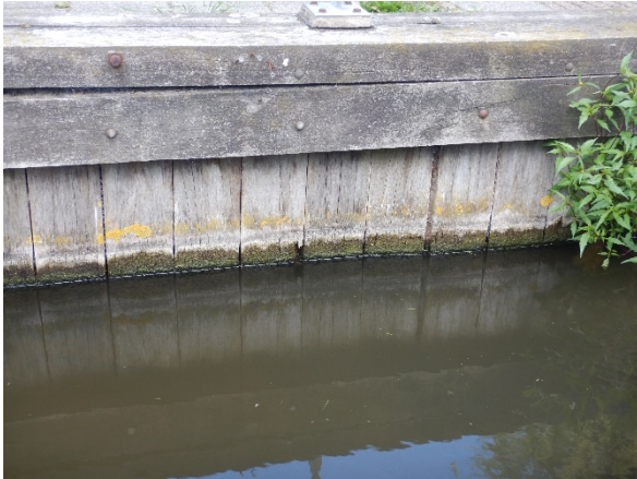
Figuur 4.16: K338 is op diverse plaatsen aangetast
