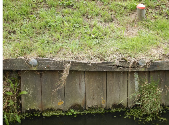
Figuur 4.17: K371 verkeert in slechte staat
