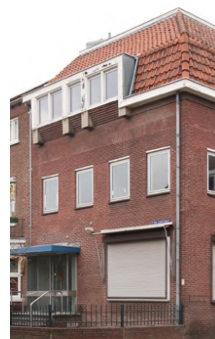
Versraling van het gevelbeeld aan de Van Cleefstraat door achterstallig onderhoud, aluminium ramen zonder onderverdeling en rolluiken.
