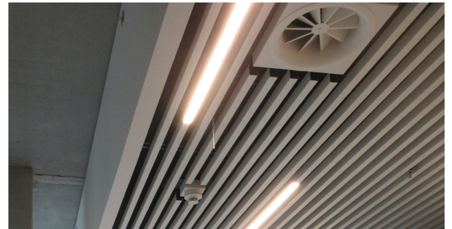
A14 technische onderdelen en verlichting geïntegreerd in plafonds witte plafonds - inbouw in wit kleur houten plafonds - inbouw in antraciet kleur
