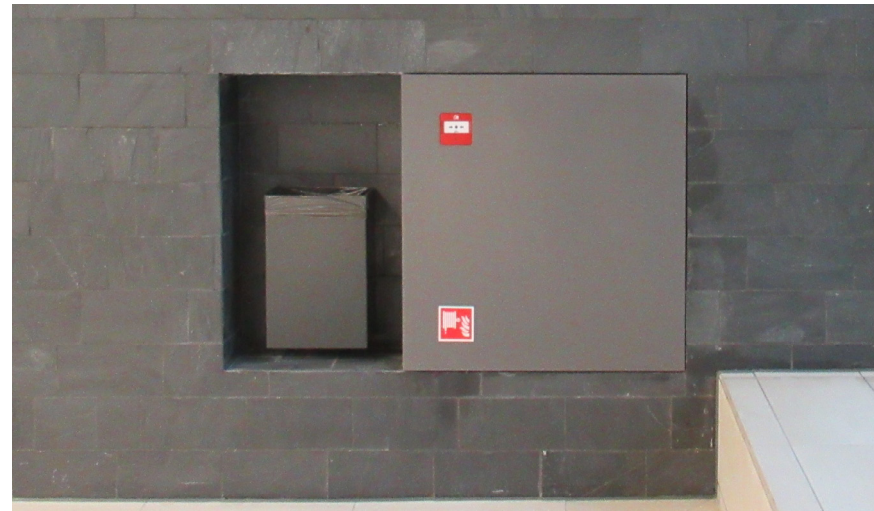
A3 in wand geïntegreerde afvalbakken en brandslanghaspels
