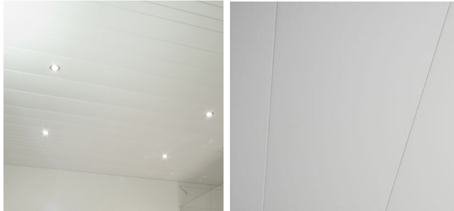
P1 Luxalon vlakke aluminium plafond Largo (wit) geïntegreerde lichten, inbouw technische onderdelen in wit plafond douches bij de recreatiebaden doucheruimte
