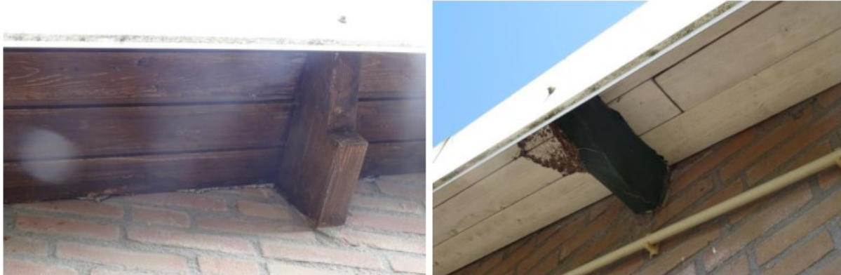
Afbeelding 9 en 10: Overstekken goed aansluitend aan buitenmuur. Bron: R.J.L. Bijvelds. Datum: 07-04-2021
