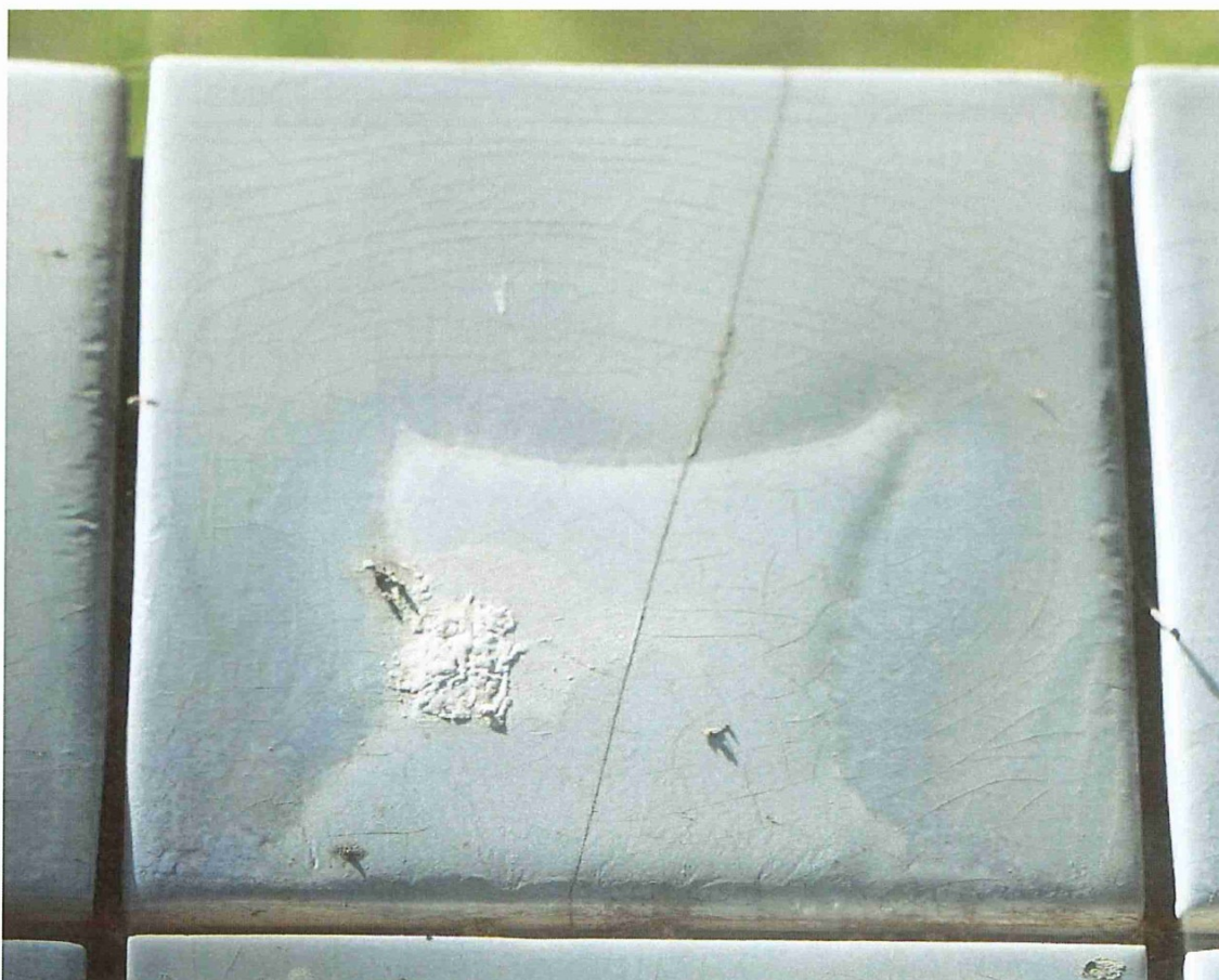
Foto 14: Tegel met scheurvorming. Het betreft een tegel die als waterslag fungeert onder een raam. Deze tegel toot eveneens aanzienlijke haarscheuren in zowel de dünnere als dikkere glazuurlaag.
