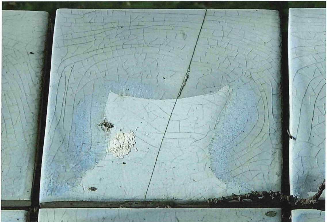
Foto 16: (2 e inspectie) Detail van foto 15. Zichtbaar is een ernstige vorming van haarscheuren in de glazuur. De scheurtjes zijn extra zichtbaar als gevolg van ingetreden vervuiling en door een toegenomen scheurwijdte.
