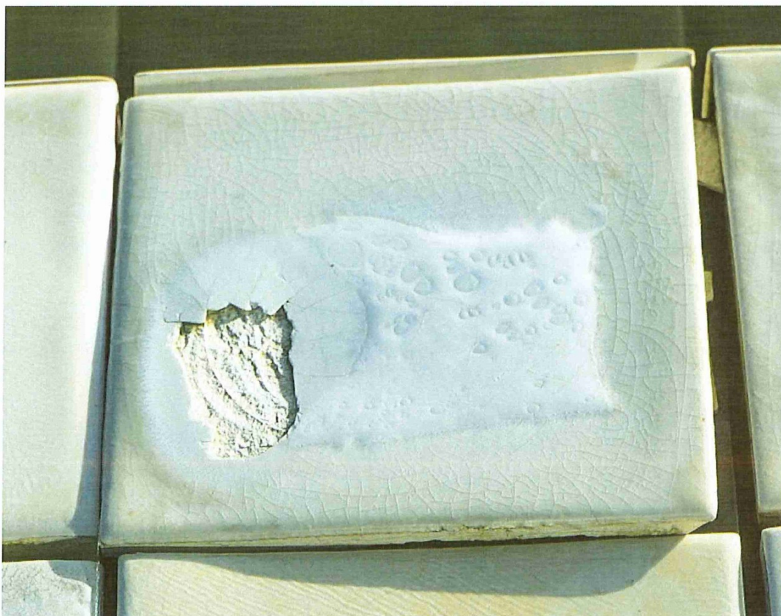
Foto 12: Losgekomen groter deel in de glazuur, mogelijk ter plaatse van een blaas in de glazuur. Tevens is veel scheurvorming in een deel van de glazuur zichtbaar en lijkt het of deze tegel onthecht is. Het betreft een horizontale tegel als waterslag onder een raam.
