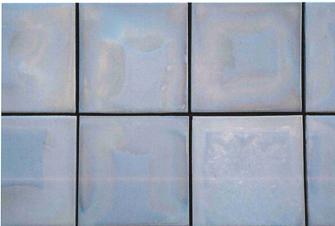
Foto 2: Een locatie waarvan verwacht mag worden dat deze niet door regen wordt belast. Hier zijn geen haarscheuren waargenomen.
