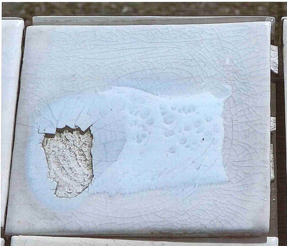
Foto 17: 2 e inspectie: De haarscheurvorming lijkt te zijn tegenomen en tevens zijn de haarscheuren beter waarneembaar geworden (zie foto 12 voor een vergelijk).
