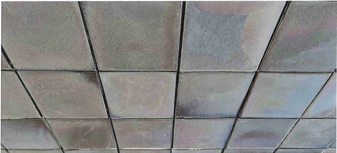
Foto 3: Plafondtegels (dus geen regenbelasting) onder de doorgang naar de tussenverdieping waarin haarscheuren aanwezig zijn (zie foto 4 voor een detail).
