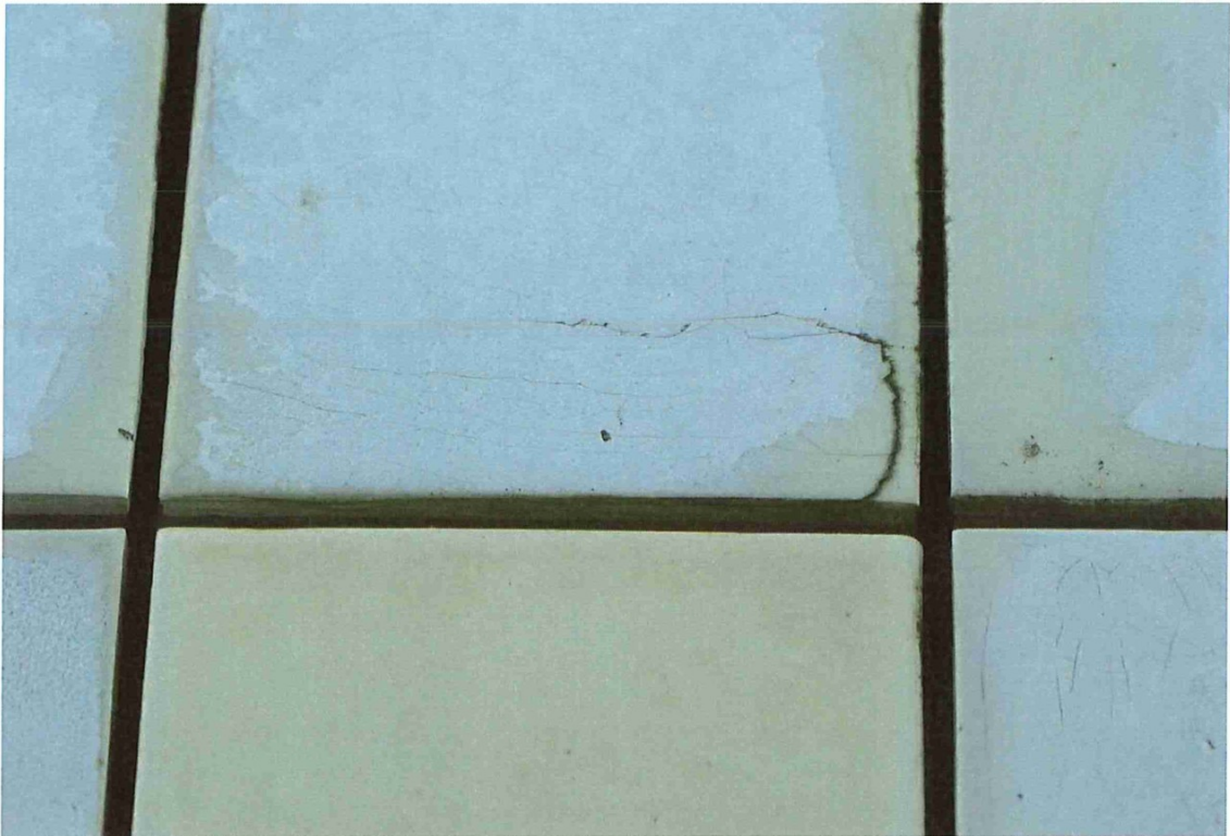
Foto 7: Zichtbaar is een tegel met lijnvormige scheurvorming in de glazuur. Het door vervuiling in de scheuren omkaderde oppervlakkige deel is waarschijnlijk al deels onthecht. Het betreft een horizontale tegel als waterslag onder een raam.
