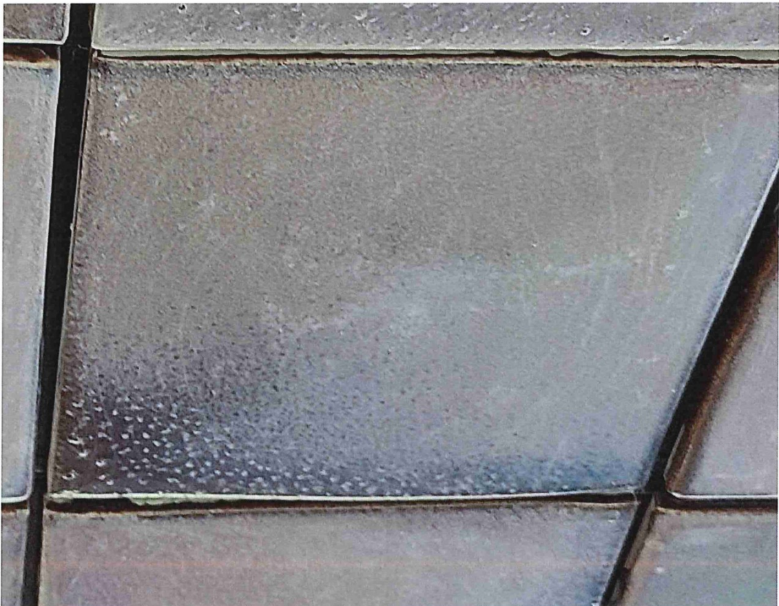
Foto 4: Detail van foto 3, waarbij de haarscheuren in de glazuur beter zichtbaar zijn.
