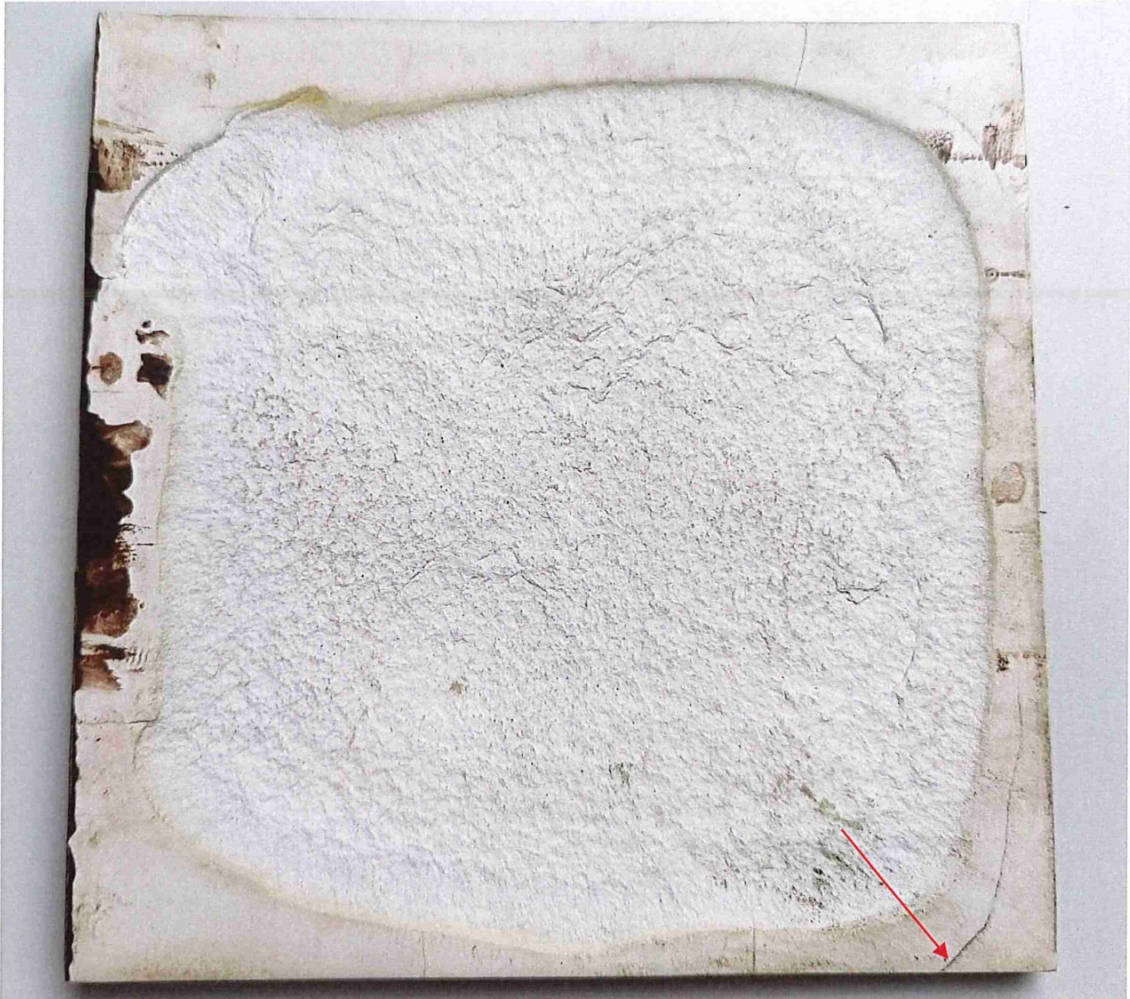
Foto 18: Zichtbaar is de achterzijde van de uit de gevel (zie foto 9) losgekomen tegel. Uit de achterzijde is een deel uitgebroken. Het uitgebroken deel bevindt zich nog tegen de gevel. In de achterzijde is meerdere scheurlijnen waarneembaar, waarvan er één doorloopt in de tegelkant (zie pijl en foto 18).
