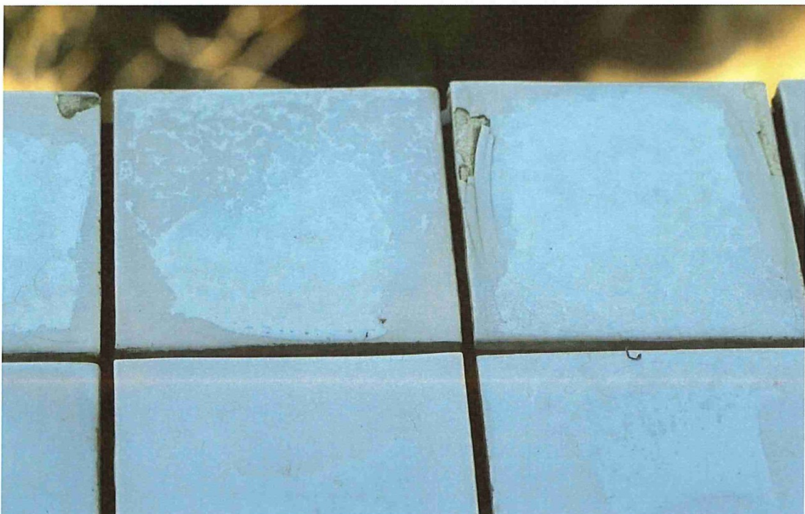
Foto 8: (1 e inspectie) Loskomende oppervlakkige delen bij twee tegels De rechter tegel vertoont lijnvormige haarscheuren in de glazuur specifiek langs de 2 evenwijdige kanten van een tegel. Het betreft een horizontale tegel als waterslag onder een raam.
