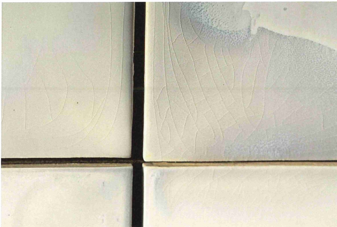
Foto 1: Haarscheuren in de glazuurlaag van tegels.
