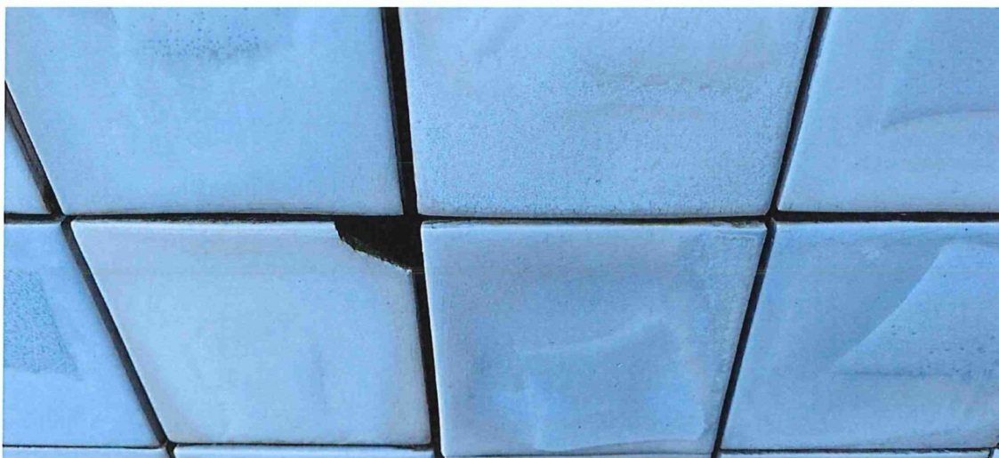
Foto 13: Tegel waarvan een hoek is afgebroken.
