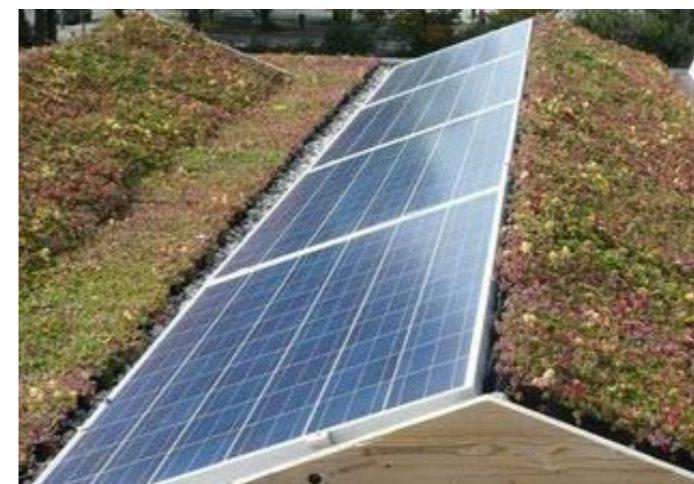
Zonnepanelen gecombineerd met sedumdak
