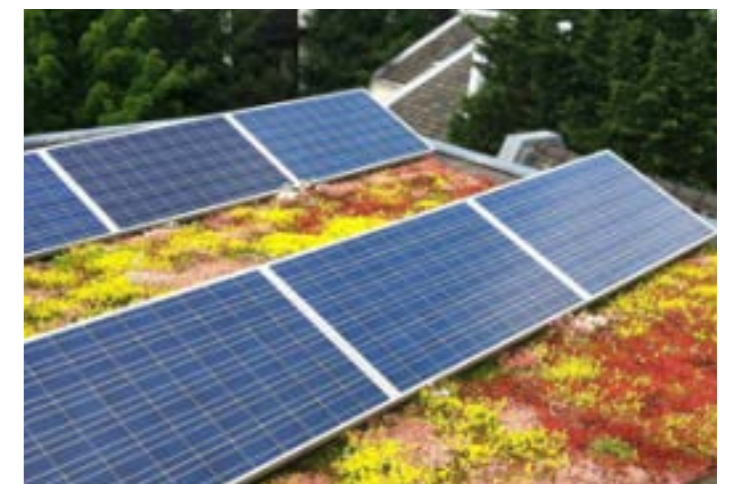
Zonnepanelen gecombineerd met sedumdak
