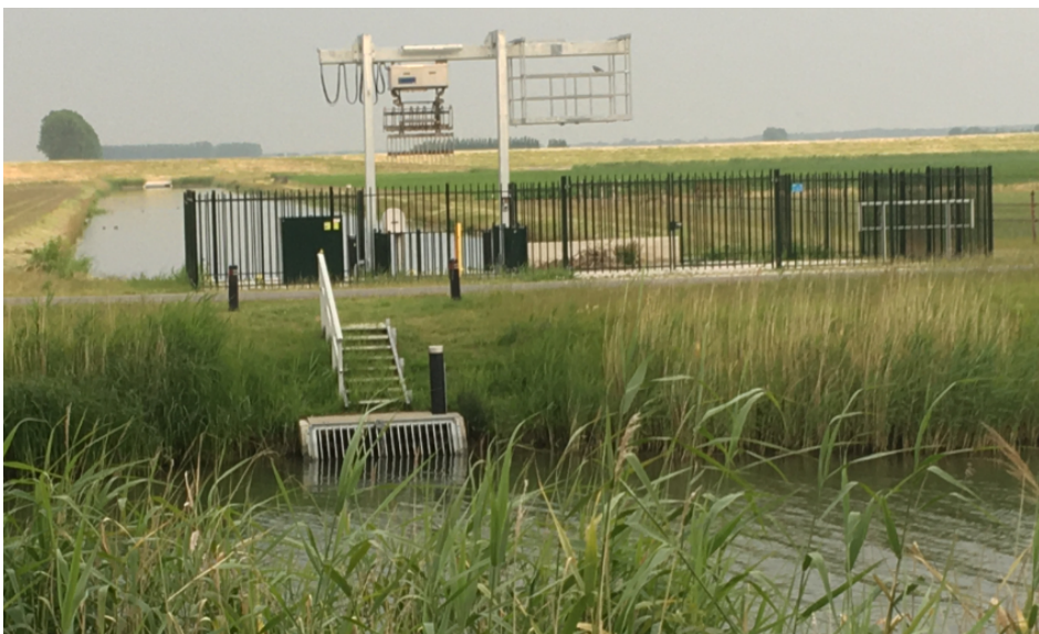
Figuur 11: Op de voorgrond de by-pass leiding bij de sifon Dirksland.
