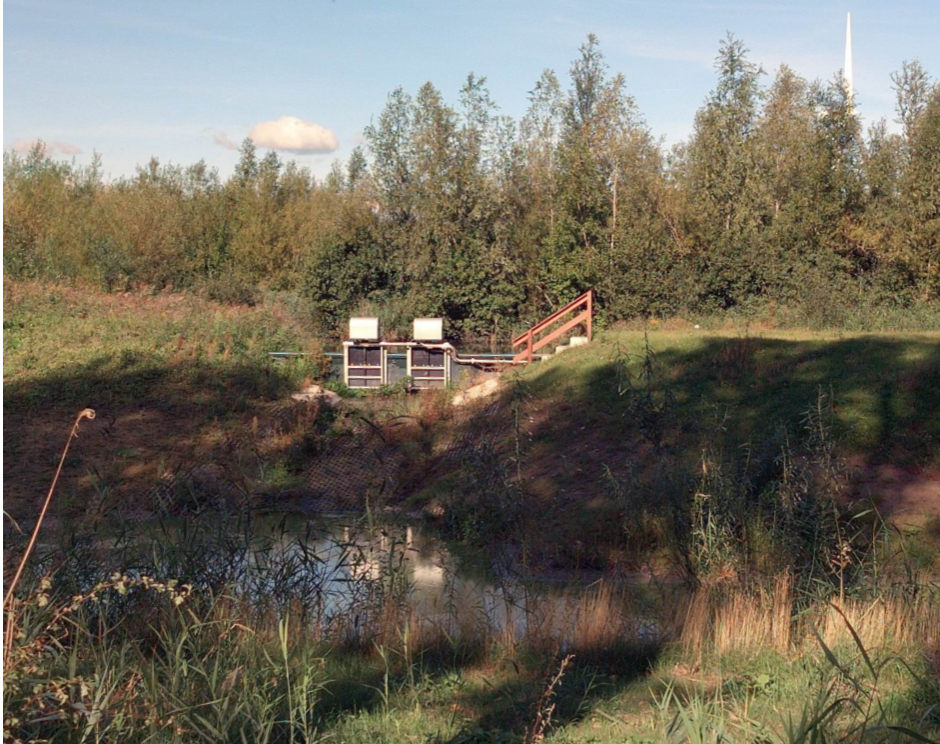
Figuur 10: Calamiteitenstuw Inlaat van Pallandt.
