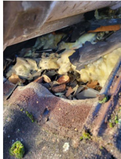
Onder dakkapel pannen nestmateriaal aanwezig. Geen zichtbare nesten. Wel weer lege noten
