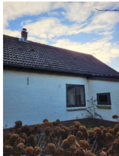
Noordzijde woning. Ongeveer 6 nesten gevonden aan deze zijde
