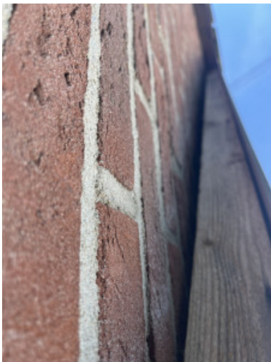
Grote hoeveelheid nestmateriaal onder dakrand.
