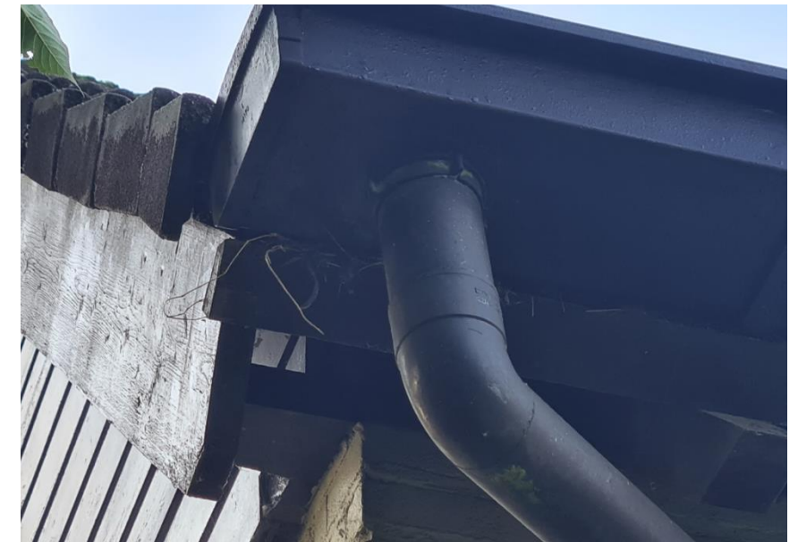
Figuur 10: Zichtbaar nestmateriaal tussen overstek en dakgoot
