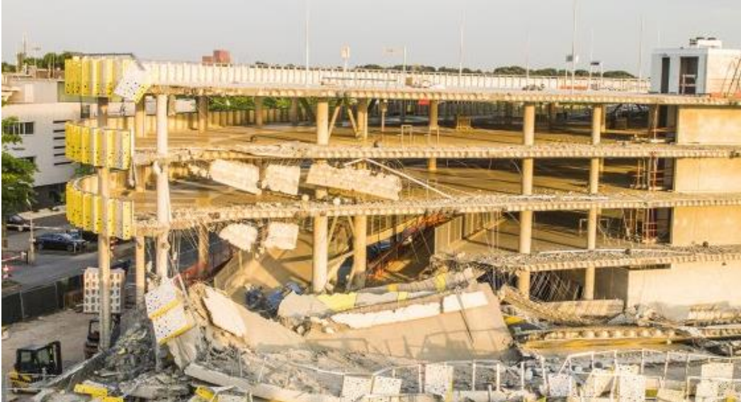
Ingestorte parkeergarage Eindhoven Airport - Sem van Rijsel
