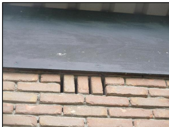
Figuur 1b Open ventilatierooster en kierende trespaplaten in het transformatorhuisje.
