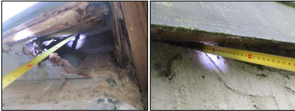
Figuur 5 Openingen zijn te groot voor vleermuizen en bereikbaar voor muizen en ratten
