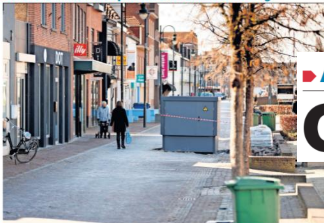
▲ De nieuwe transformatorkast staat op straat tegenover damesmodezaak Dot. Het oude transformatorhuisje is rechts op de foto nog te zien. Het ligt verdiept zodat het geen overlast oplevert. FOTOGRAFIE: OTTOMER/STUDIO-4
