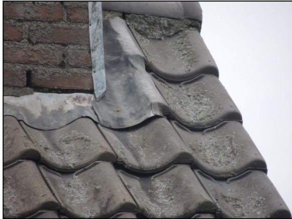
Figuur 16. Geschikte openingen in de schoorsteen en onder loodflappen van het woonhuis.
