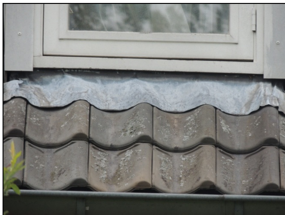
Figuur 18. Geschikte spleten onder de dakpannen en onder loodflappen van het woonhuis.
