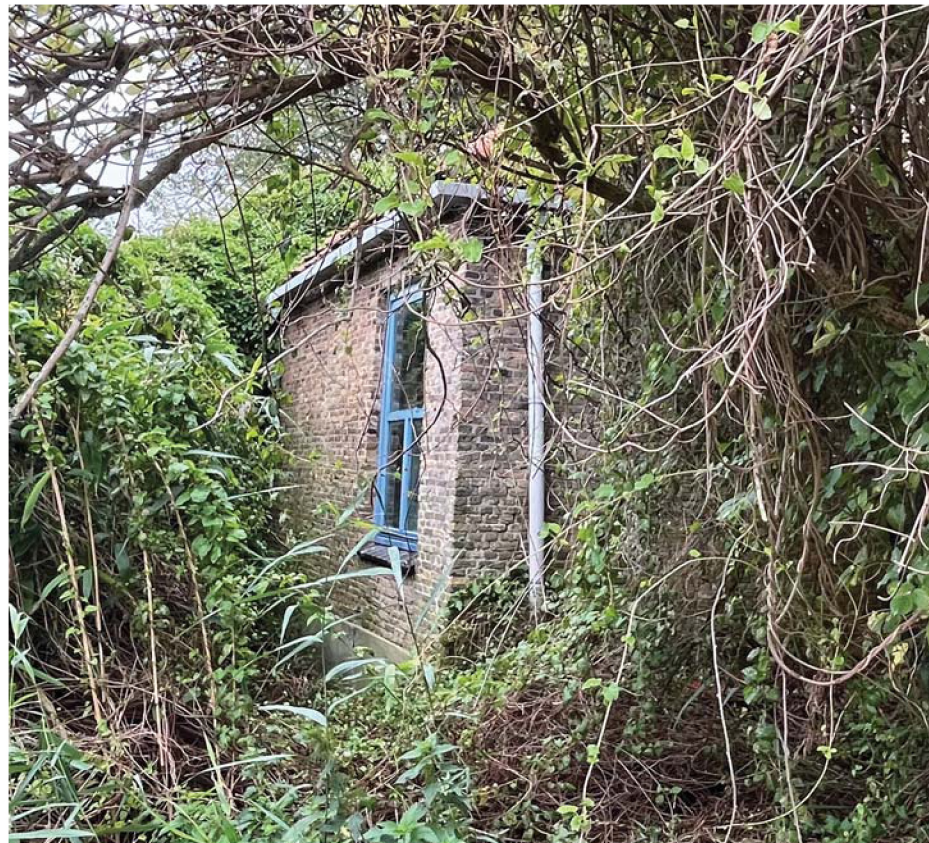
Opname van de achterzijde van Lies Frankenweg 1. Nog net zichtbaar is het wolfseind. Onder de goot zitten stropen (ogen) voor muurankers. Deze zijn zo dicht tegen de goot geplaatst dat de schieter (verticaal deel) niet geplaatst kan worden. Dit doet vermoeden dat de gevel hoger opgemetseld is geweest vergelijkbaar met de situatie op de foto rechts.
