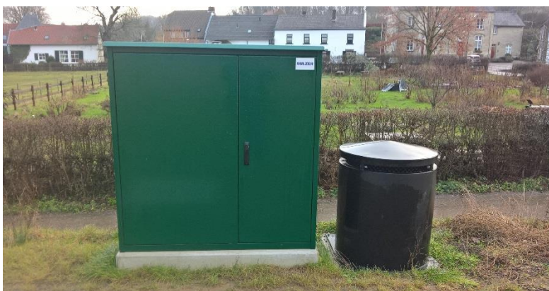
Figuur 4-a Complexe installaties vragen meer onderhoud
