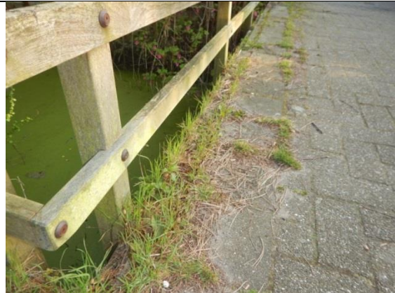
Slordig uiterlijk door overmatige begroeiing ter plaatse van het kunstwerk.
