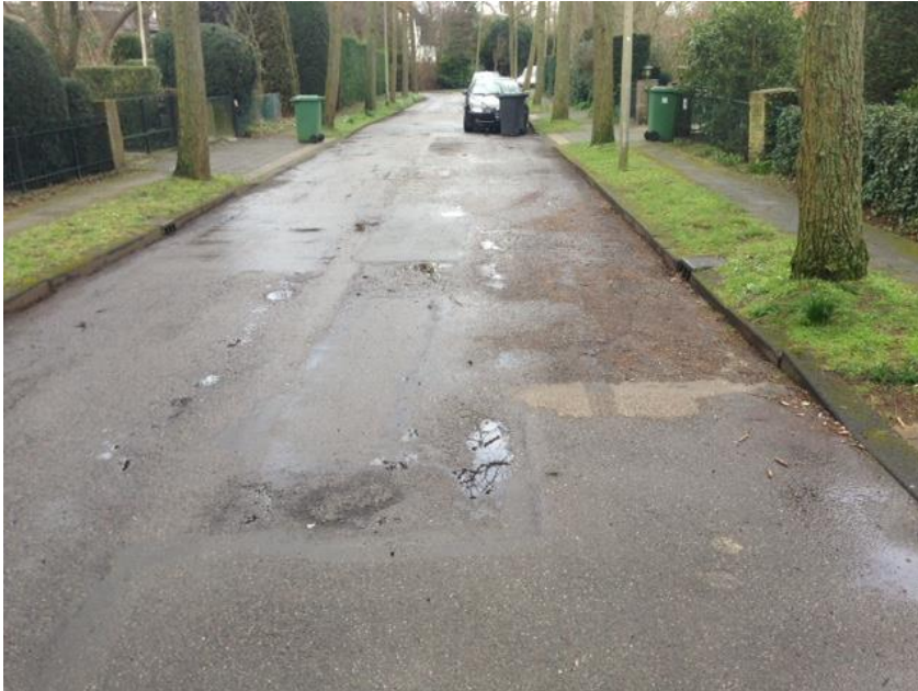
Voorbeeld van schade aan asfaltverharding
