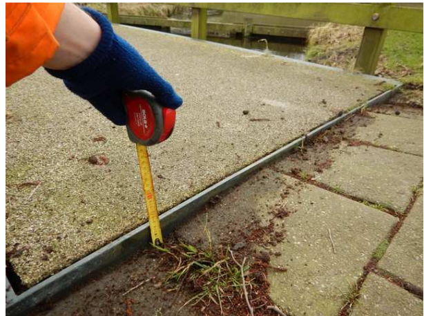
Struikelgevaar door verzakking tegelwerk
