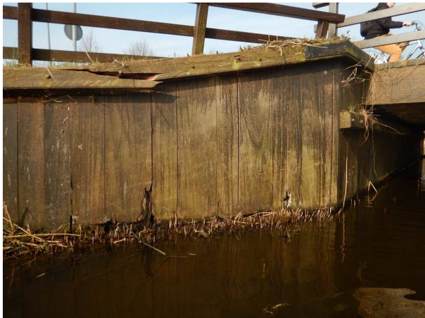
Kans op bezwijken damwand bij boven belasting a.g.v. houtrot
