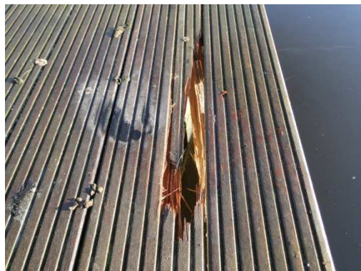
Foto 2 Schade aan steigerplank
