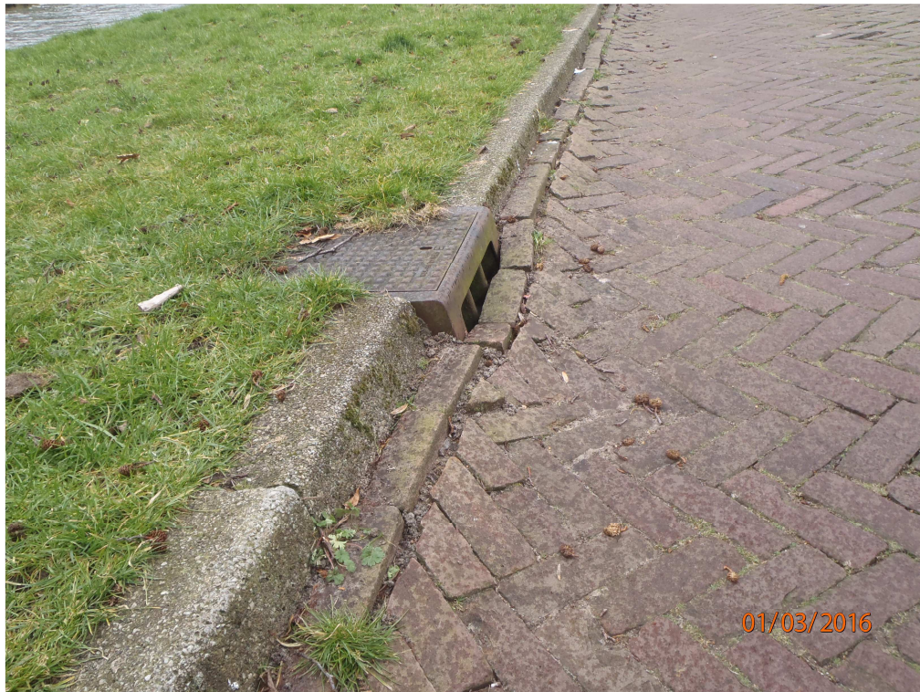
Voorbeeld van voorkomende kleine schade (klein onderhoud)
