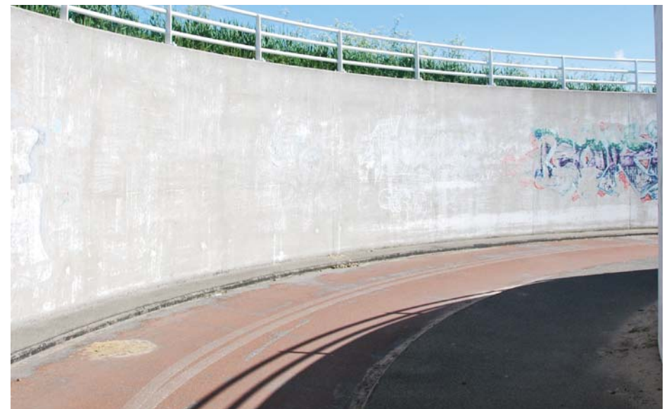
↑ BESTAANDE BETONNEN KEERWAND OOSTKANT VAN HET TE BEHOUDEN DEEL VAN DE FIETSTUNNEL.
