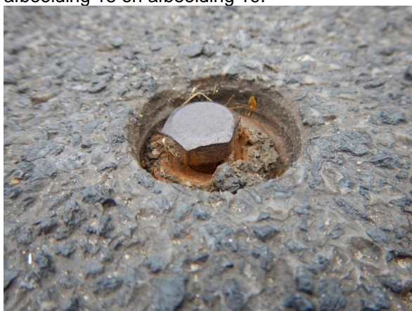
Afbeelding 18: 10BV05 Losse bevestigingsmiddelen bovenzijde
