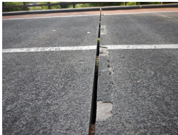
Afbeelding 15: 02BV12 Rand ter plaatse van dilataties afgebroken
