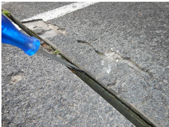
Afbeelding 14: 02BV12 Rand ter plaatse van dilataties afgebroken
