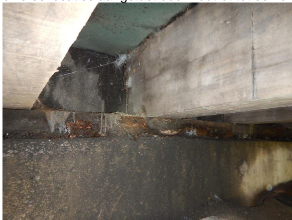
Afbeelding 20: 02BV12 Houtrot oplegbalk
