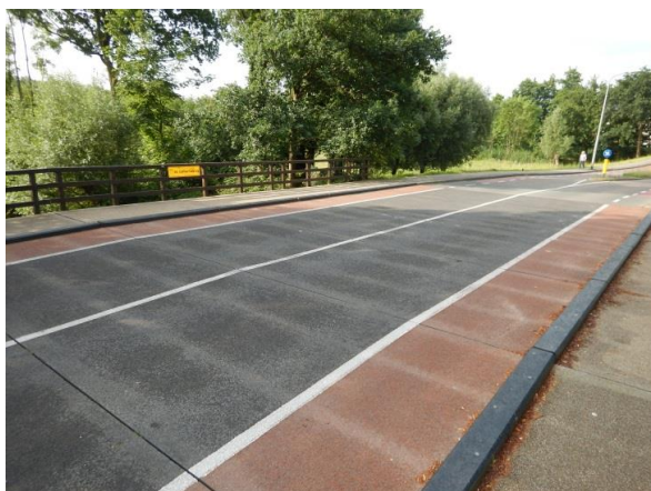
Afbeelding 4: 02BV12 Scheurvorming overzicht (lichte strepen op dek)
