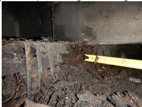
Afbeelding 21: 02BV12 Houtrot oplegbalk
