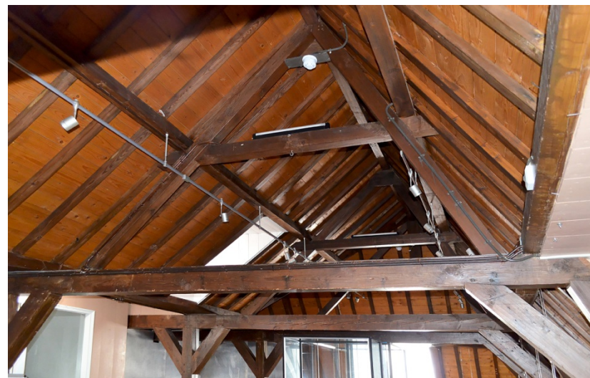
227. Baljuwhuis, zolder, kap van omstreeks 1740 vanuit het noorden, een A-spant met ongelijke benen van de westelijke kapbeuk, op één van de onderscheerjucken.
