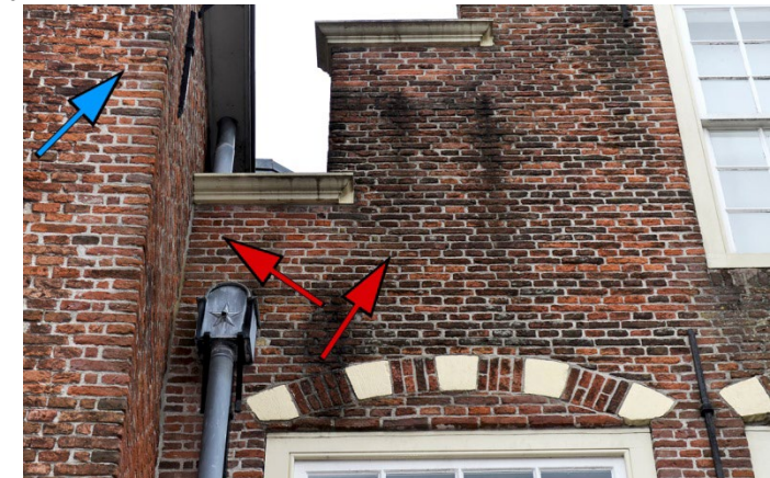
101. Ambachtshuis, achtergevel (noord), detail van de oostzijde; het metselwerk is ter plaatse van de treden in 1980-1982 hersteld of zelfs vervangen, toen ook de dekplaten van Franse kalksteen (Vaurion) zijn aangebracht. De pijlen wijzen naar klezoren (= kwarten van een baksteen in de lengte), ook bij de westbeuk van het Baljuwhuis (links: 1640-1641).
