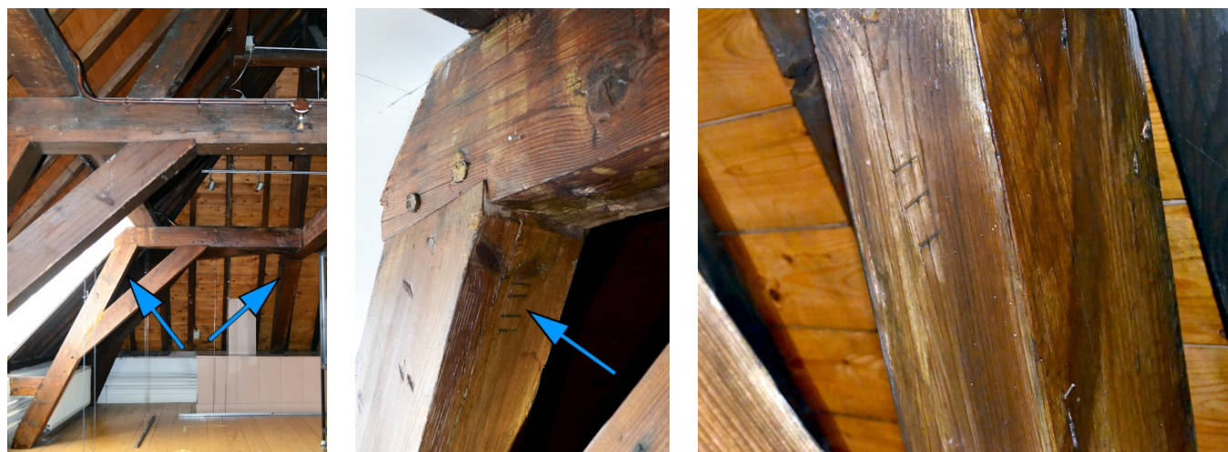
29. Baljuwzolder, westbeuk, zuidelijke been van het oostelijke noord-zuidgerichte jukspant; pijl wijst naar een telmerk, 2021.
