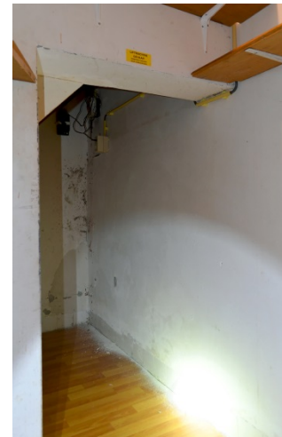
122. Ambachtshuis, kelder (vm. kerker) vanuit het noorden; de zuidmuur dateert van 1980-1982, toen een deel van de kelder is afgenomen t.b.v. de toiletten, toen ook de zuidkant van het gewelf is gesloopt t.b.v. van de nieuwe trap naar de zaal.
