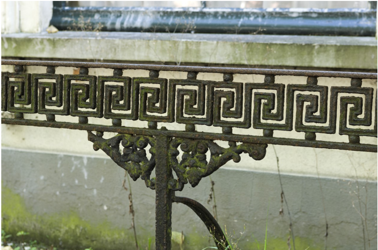
Figuur 18 Het rijksmonument Voorstraat 39 bevat veel oorspronkelijke details. Door gebruik te maken van de financieringsmogelijkheden van het NRF heeft de eigenaar met veel zorg de restauratie van dit beeldbepalende pand kunnen realiseren. Situatie voor de restauratie in 2014. (beeldbank Rijksdienst voor het Cultureel Erfgoed, Amersfoort, nr. 12231-36923)
