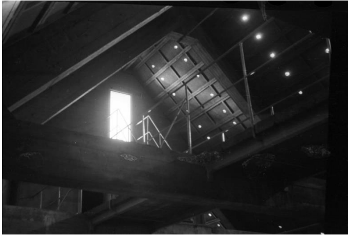
85. Op beide afbeeldingen zicht op de zolderruimte, in oostelijke richting met zicht op ruimte 91 en 402. De zolderruimte is min of meer onveranderd gebleven. De voornaamste wijzigingen zijn de kabels voor elektra en verbindingen die zijn gelegd. De deuren van de ruimtes zijn verdwenen en na de Tweede Wereldoorlog weggehaald ten behoeve van hergebruik elders. Op deze foto's zijn de dakpannen niet aanwezig, vandaar de lichtinval door de gaten in de bimsbetonplaten. Foto 1947. (Herkomst: beeldbank NIMH, objectnummer 2155_011537 en 2155_011536)
