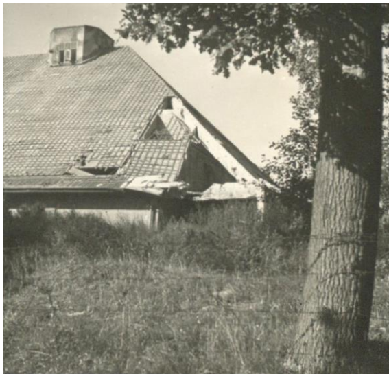
74. De door de bominslag beschadigde zuidoosthoek. De gevolgen zijn nu nog te herkennen aan het herstel met houten gordingen en houten dakbeschot. Tevens is de schade aan de betonbalk boven de zijruimte zichtbaar. Links de dichtzetting van de zijruimte aan de zuidkant, waarop met moeite de geschilderde baksteenmuur is te zien. Het terrein is hier nog niet geëgaliseerd. Foto 1947. (Herkomst: beeldbank NIMH, objectnummer 2155_501985)
