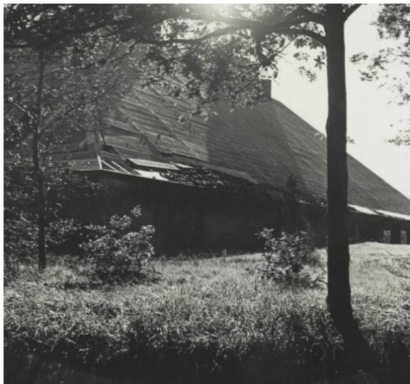
72. De noordzijde van de bunker met schade. Links is de opbouw van de onderzijde van het dak zichtbaar. Dit deel van het dak, dat het dakoverstek vormt, is in hout uitgevoerd. Het dakoverstek is nadien enkele malen hersteld, maar dateert in oorsprong nog uit de bouwtijd. Foto 1947. (Herkomst: beeldbank NIMH, objectnummer 2001_N0000119-03)
