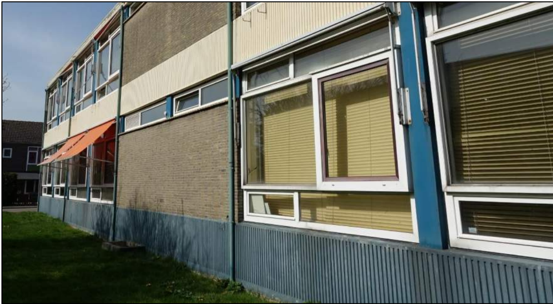
Figuur 7: Zijgevel van het opstal opgetrokken uit baksteen en platen waar alles, inclusief kozijnen, goed aansluit.
