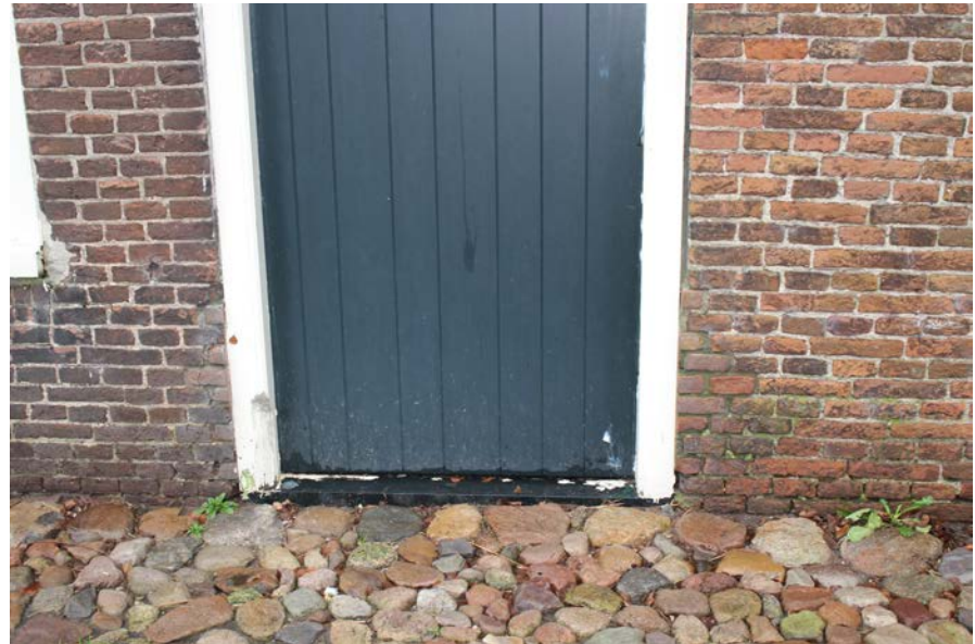
7. De deur is aan de onderzijde ingebroken. Het is een venster geweest.
