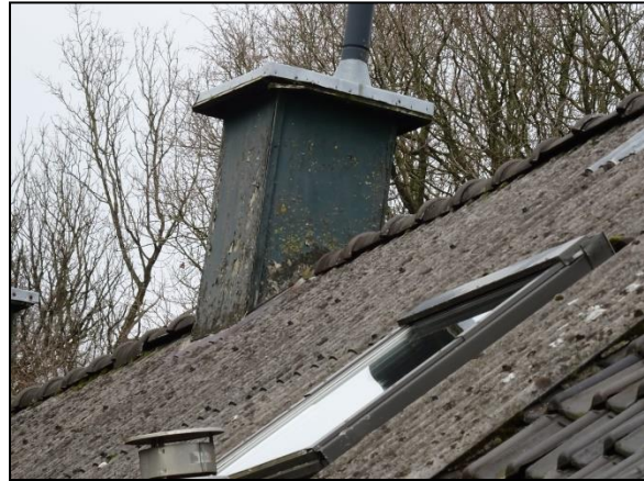
Figuur 17. Ruimte tussen nokpannen en dakplaten.
