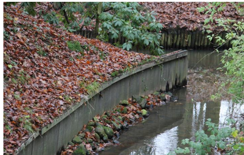
Er is gebruik gemaakt van verschillende typen beschoeiingen. Op de bovenste afbeelding is te zien dat de beschoeiing op enkele plekken in slechte staat verkeert.
