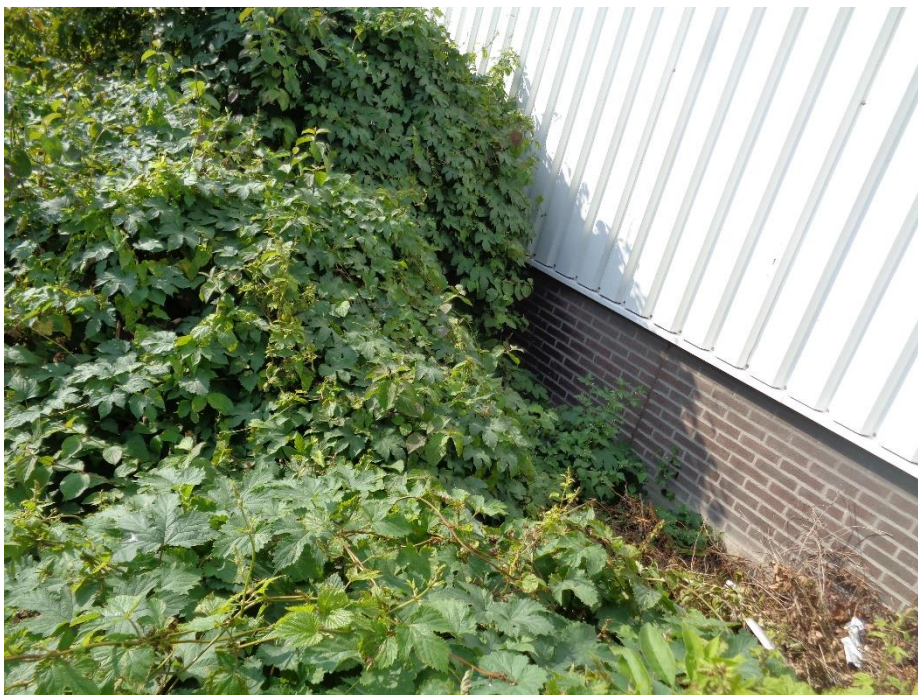
Figuur 9. Verwilderde begroeiing aan de zijkant van de loods
