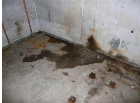
morsvlekken op keldervloer
