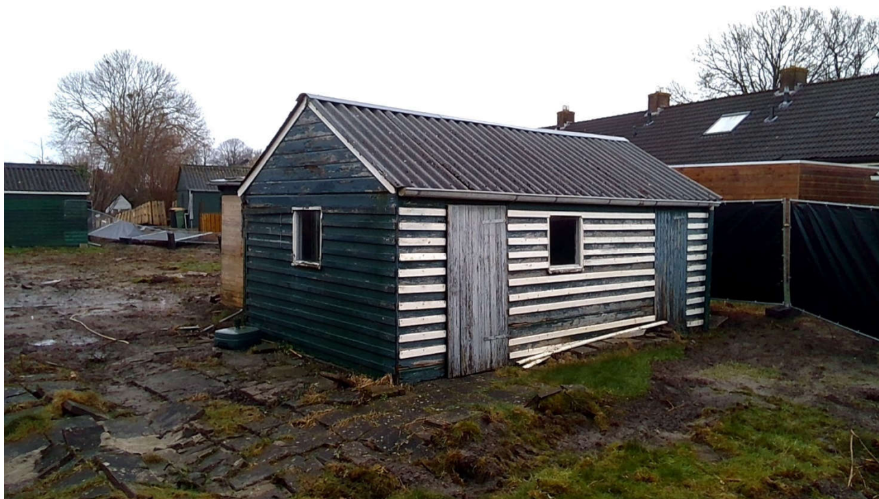
Afbeelding 5.3: Schuurtje (2) met asbest verdacht dak.
