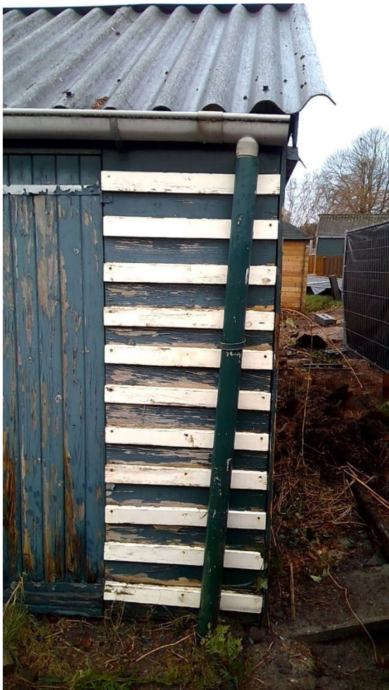
Afbeelding 5.6: Dakgoot met regenpijp. Dakgoot loopt niet door tot het einde van het dak.
