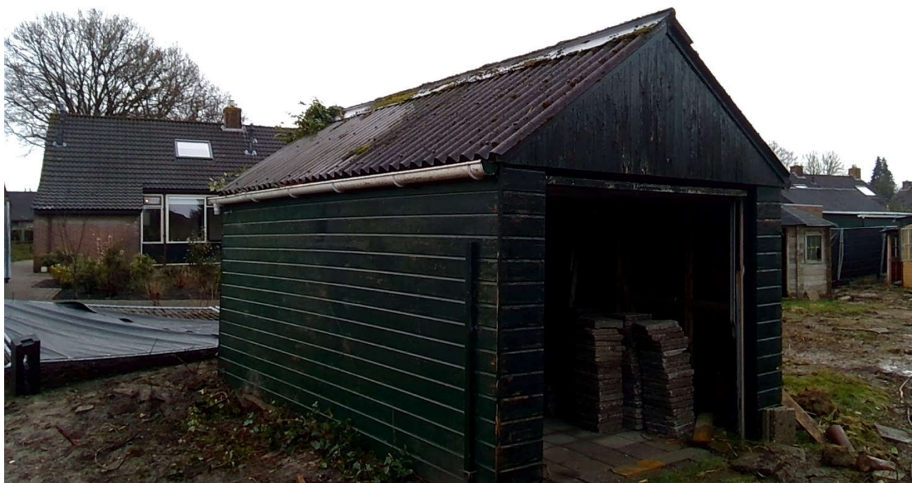
Afbeelding 5.4: Schuurtje (1) met asbest verdacht dak.
