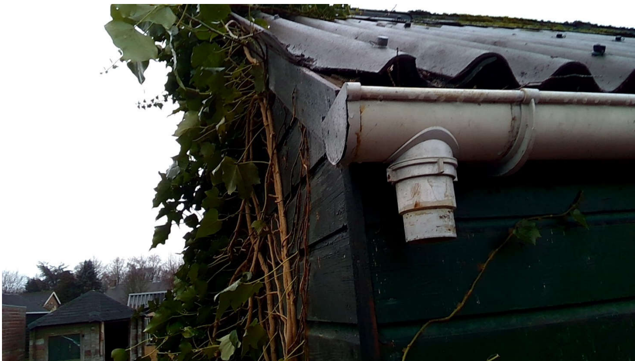
Afbeelding 5.5: Dakgoot met een regenpijp die niet meer aanwezig is.
