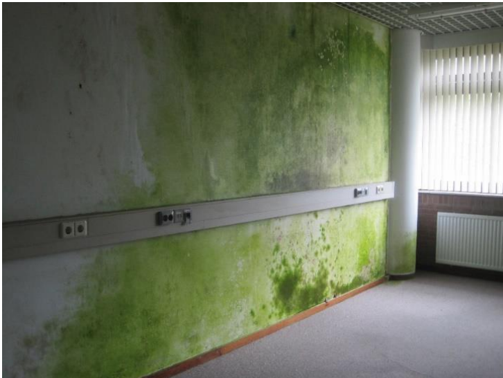
Figuur 67. Impressie kamer met waterschade.
