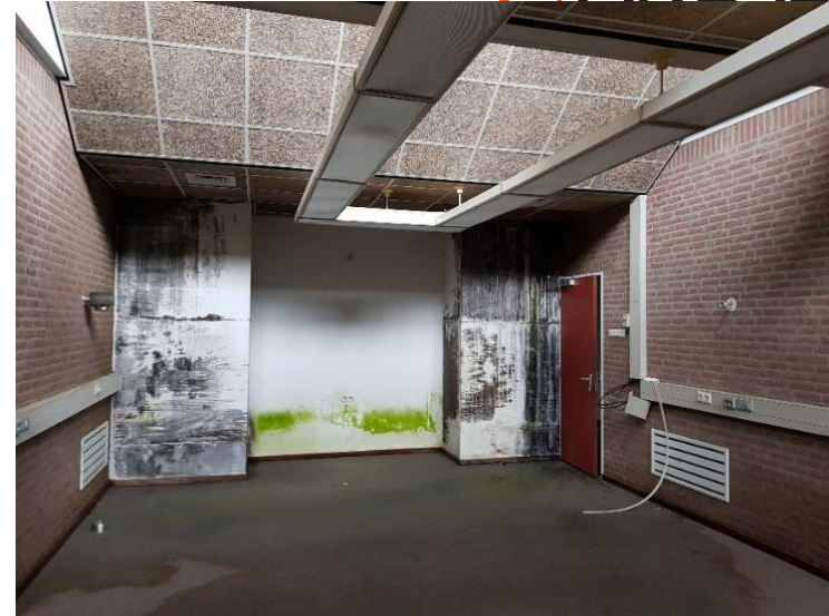
Figuur 66. Impressie zaal met systeemplafonds, waterschade.
