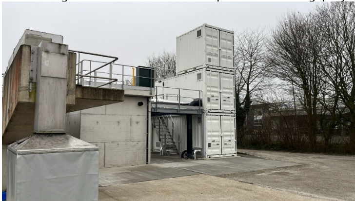
Figuur 28 Cellulose Terugwininstallatie in containers AWZI Zeewolde
