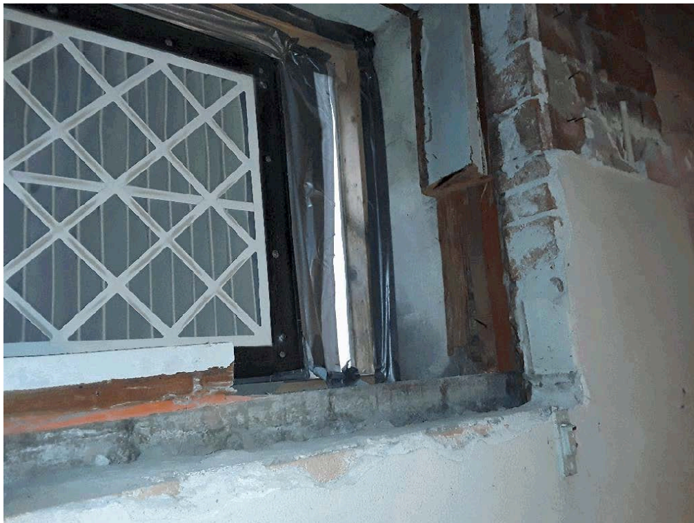
Souterrain gevel binnentuin, stelmetaal onder vensterbanken hout en karton, naast bronnen geen andere kit/afdichting aangetroffen
