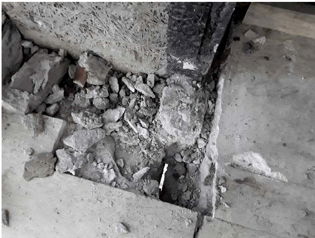
1e verdieping dilatatie, geen afdichting over/tussen constructievloer aangetroffen
