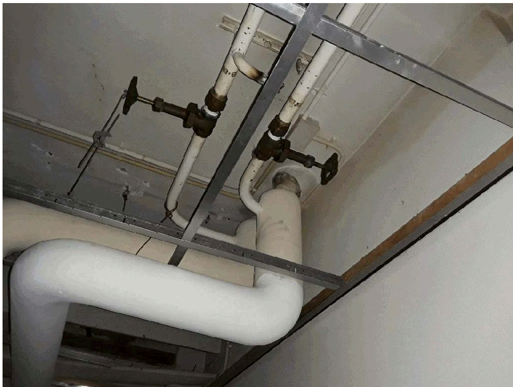
Souterrain technische ruimte, kanaal t.b.v. kabels i.p.v. ventilatie DAP bron 28
