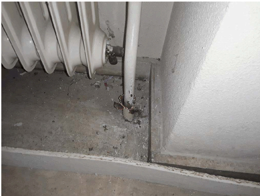
Diverse verdiepingen, geen koord rondom c.v-leidingen aangetroffen
