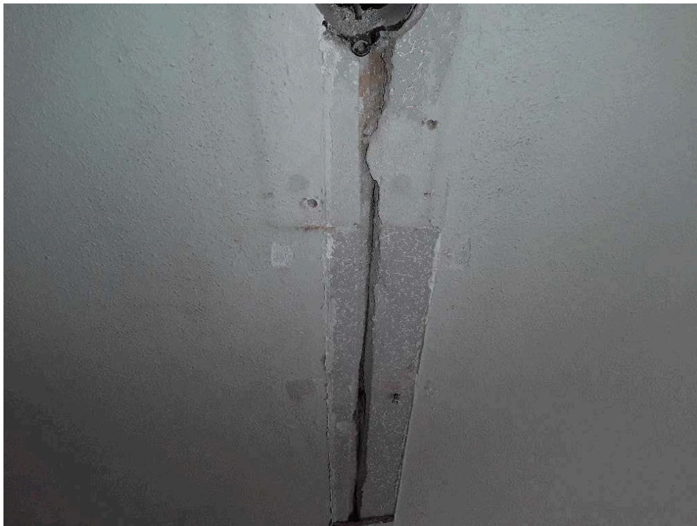
1e verdieping dilatatie, geen afdichting over/tussen gemetselde wand aangetroffen
