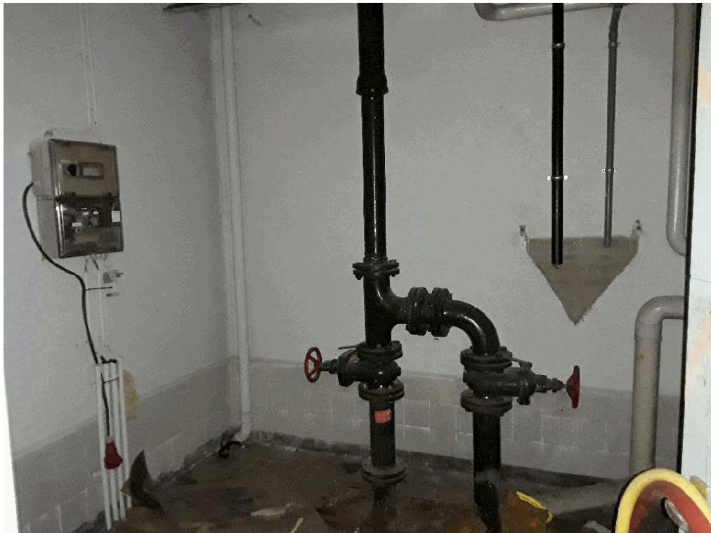
Souterrain technische ruimte, 2 stuks stopbuspakkingen (Boot bron 229-040) geen flenspakkingen DAP bron 9 (aangetroffen pakkingen rubber)
