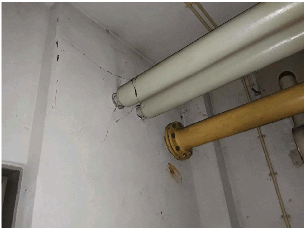
Souterrain gasmeterruimte, 2x 2 stuks koord DAP bron 3
