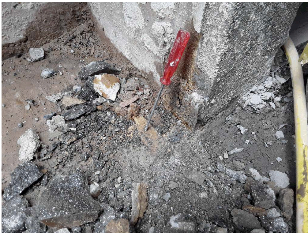
Souterrain ter plaatse van hellingbaan, onder betonelementen hout als stel materiaal aangetroffen
