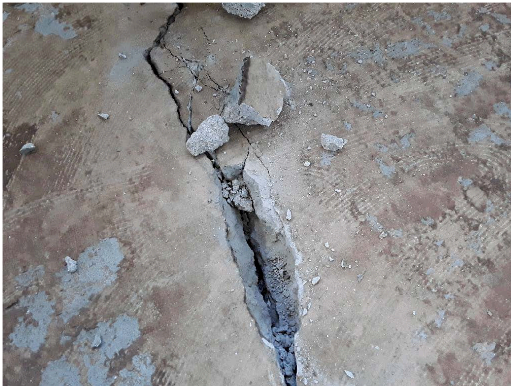
3e verdieping dilatatie, tempex afdichting tussen constructievloer aangetroffen
