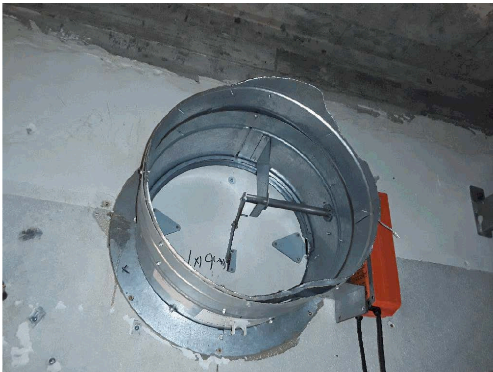
Souterrain, in ventilatiekanalen diverse niet asbestverdachte brandkleppen aangetroffen
