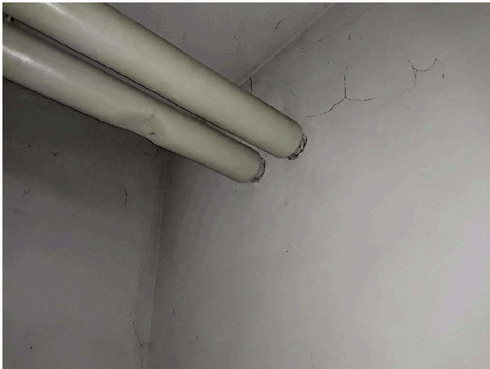
Souterrain gasmeterruimte, 2x 2 stuks koord DAP bron 3
