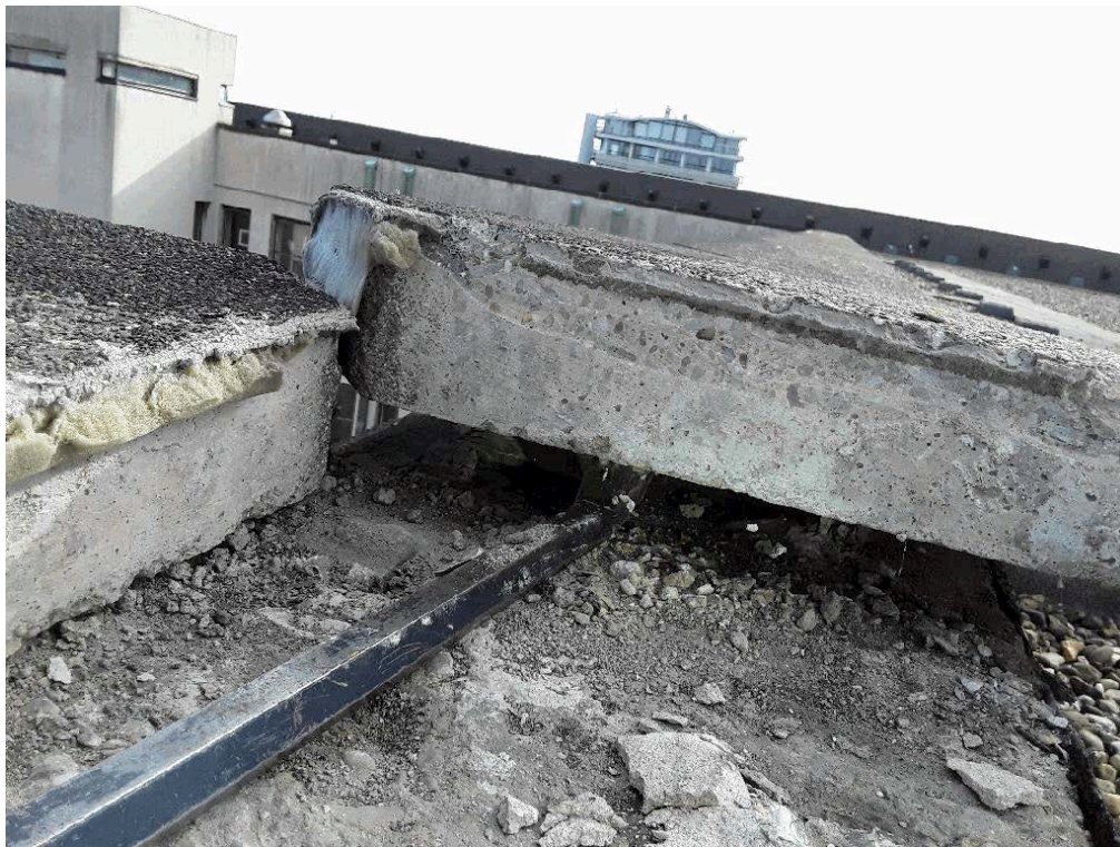
Dak ter plaatse van de binnentuin, onder betonnen elementen houten wiggen als stel materiaal toegepast (afdichtingskit niet asbesthoudend bron 24 en 32)
