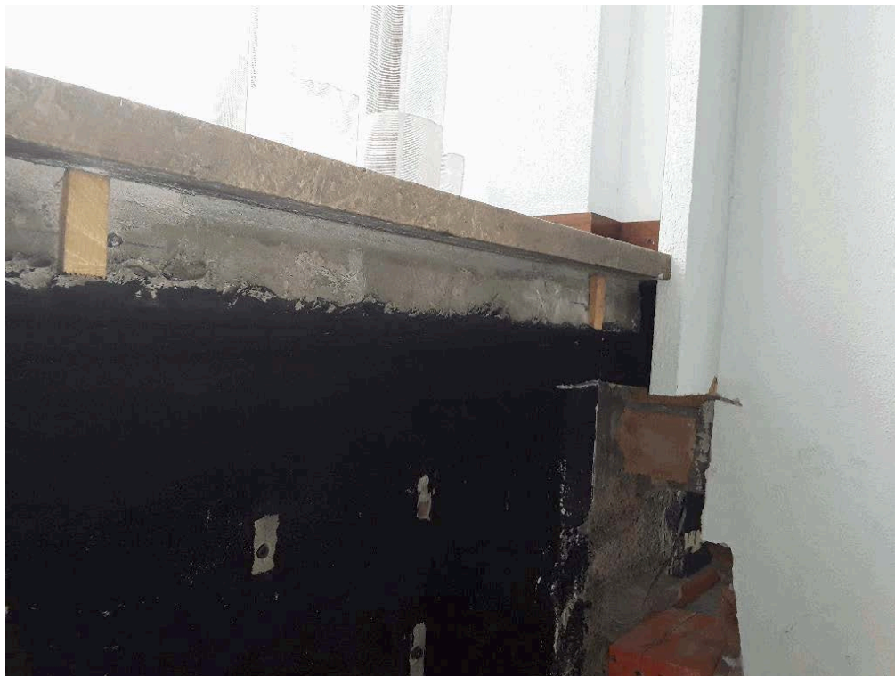
Diverse verdiepingen binnenzijde gevel, houten stelplaatjes onder (natuursteen) vensterbanken
