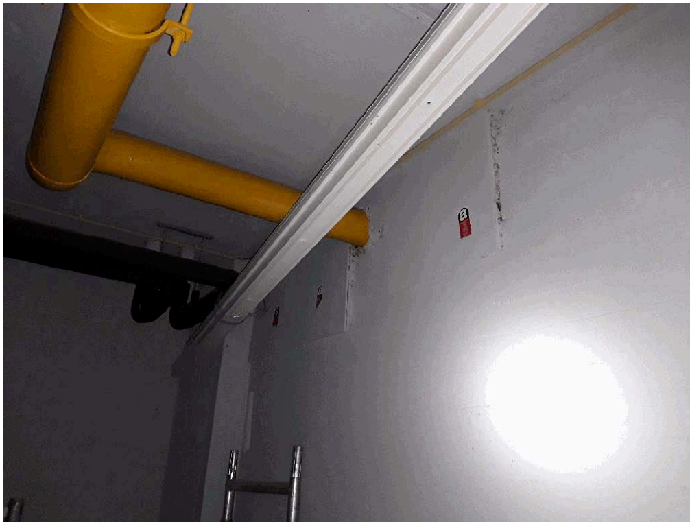
Souterrain oorspronkelijke technische ruimte, asbeststickers op afscherming DAP bron 5
