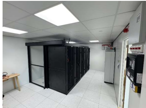
Figuur 35 Gerenoveerde serverruimte
