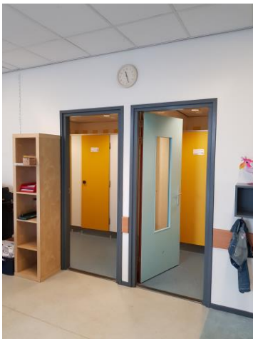
Afbeelding: In toiletten blijft het licht de hele dag branden, overweeg de plaatsing van een bewegingsmelder met een nabrandtijd van 10 minuten.
