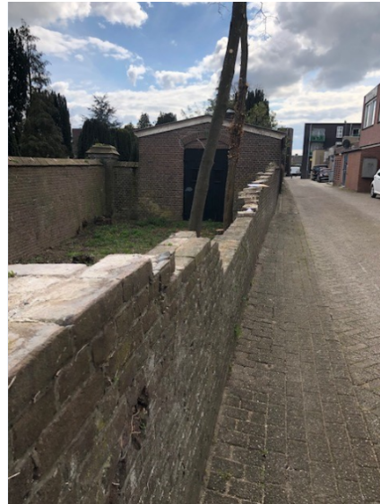
Het gemeentelijk deel van de muur is bij de fundering afgebroken en moet opnieuw worden opgetrokken en verstevigd
