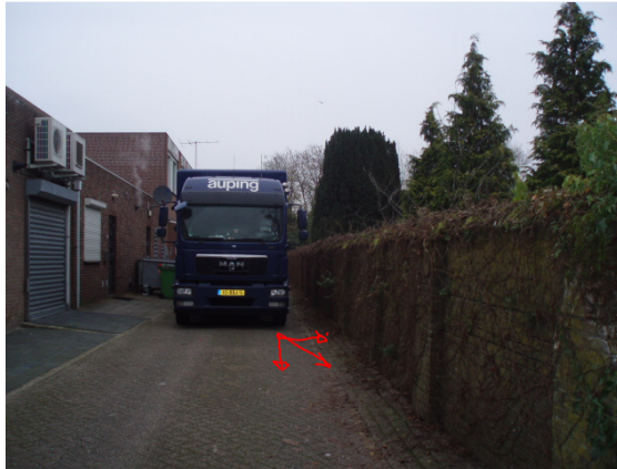
Bevoorravingsverkeer op de Molenhoek zorgt ook voor beschadiging van de RK Begraafplaatsmuur
