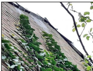
Figuur 15. Ruimtes onder de kant- en nokpannen bij kopgevel van de schuur van Van Vredenburgweg 97.
