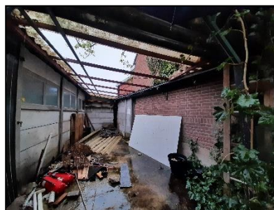
Figuur 10. Kapot bouw materiaal onder afdak naast de te slopen schuur in de zuidwestelijke hoek van de onderzoekslocatie.
