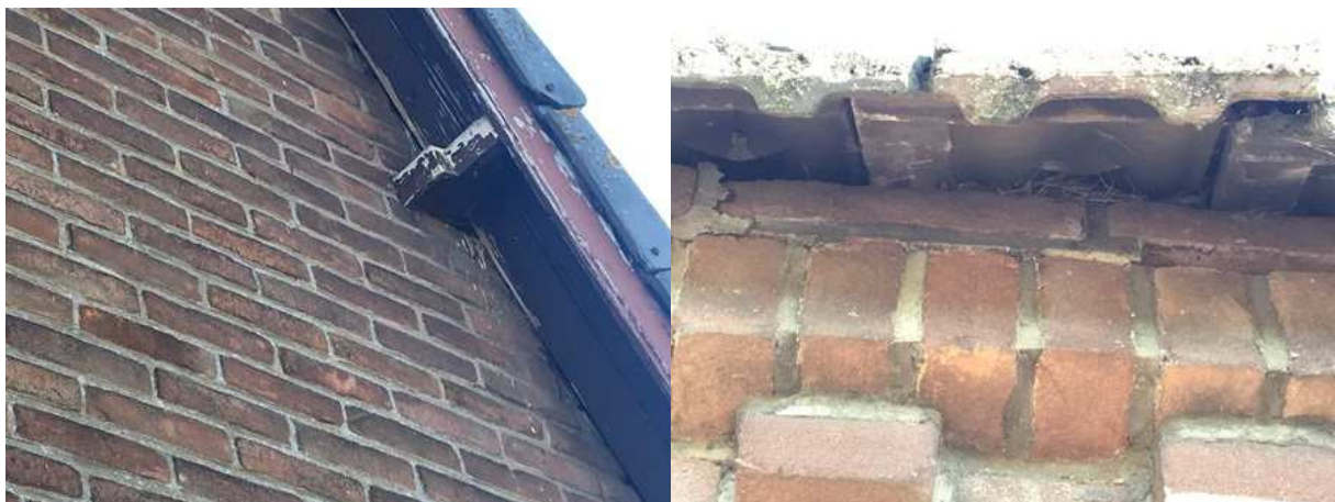
Foto links: invliegopening naar een bezet nest onder de dakkannen aan de voorzijde van de woning. Foto rechts; nestmateriaal van een huismussennest onder de dakpannen.
