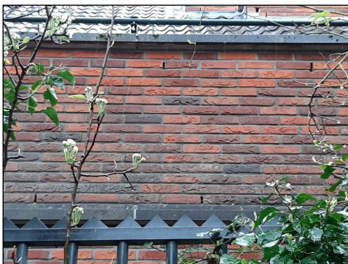
Figuur 19. Open stootvoegen in de noordelijke gevel van de bebouwing op de Park de Wervelaan 1.
