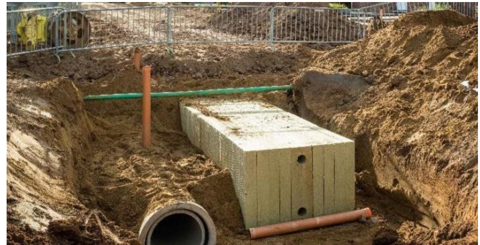
Figuur 5-2 Rockflow: een infiltratievoorziening die wordt toegepast in de wijk Bijvanck.
