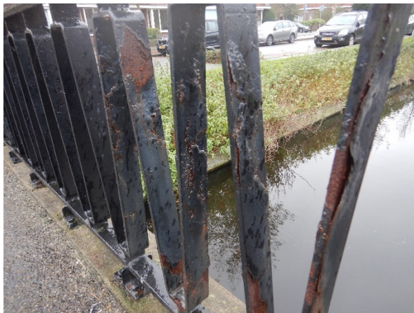
Figuur 4.3: Corrosie leuning B004
