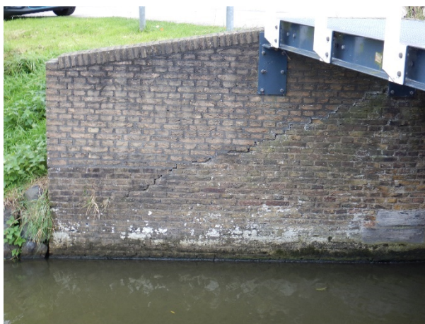
Figuur 4.5: Scheur in vleugelwand A019.
