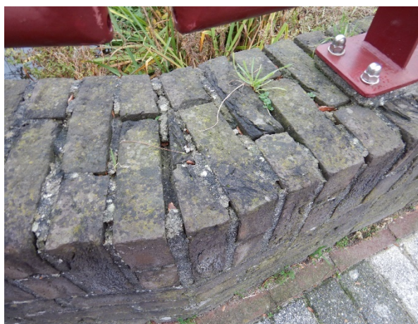
Figuur 4.6: Ontbrekend voegwerk borstwering A013.
