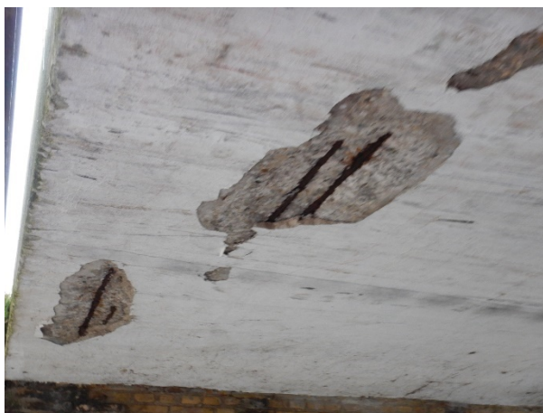
Figuur 4.1: Betonschade onderzijde dek brug A019.
