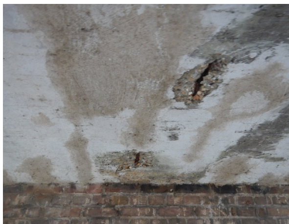
Figuur 4.2: Betonschade onderzijde dek brug A021.
