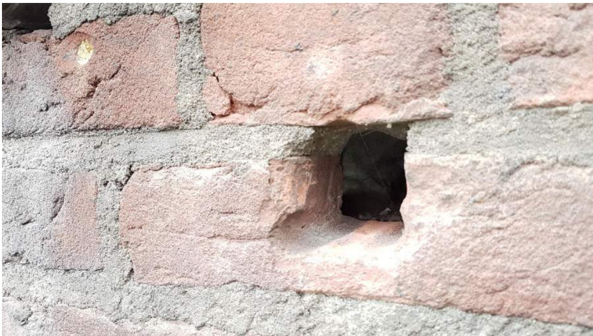
Foto 7: een van de gaten in de gevel, met de spouw zichtbaar (licht grijs).
