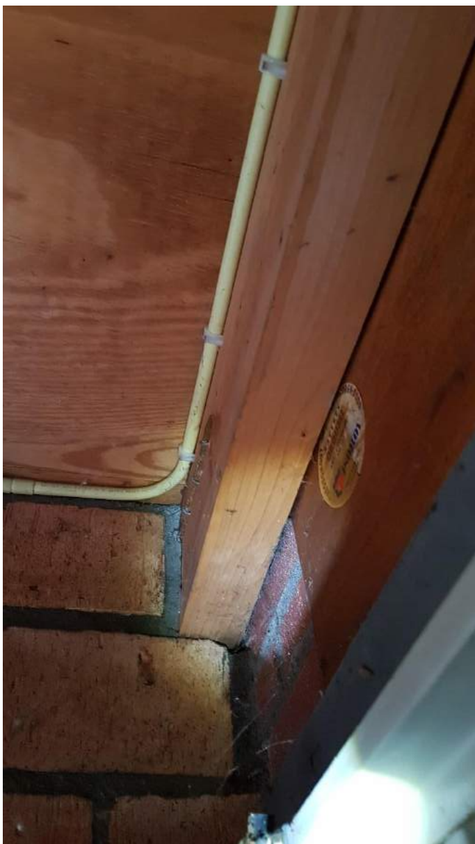
Foto22: opening van binnen naar de spouw, hieronder zijn keutels aangetroffen.
