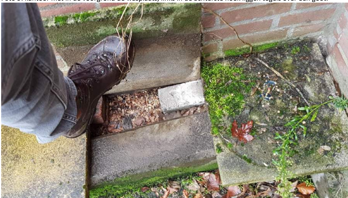
Foto 10: nestmateriaal van een muis of rat in de goot onder de tegels.
