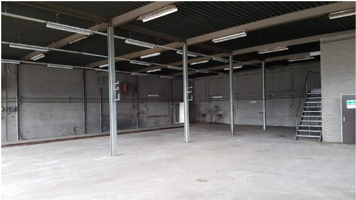
Foto 3: de lege bedrijfshal en dak zonder dakbeschot.
