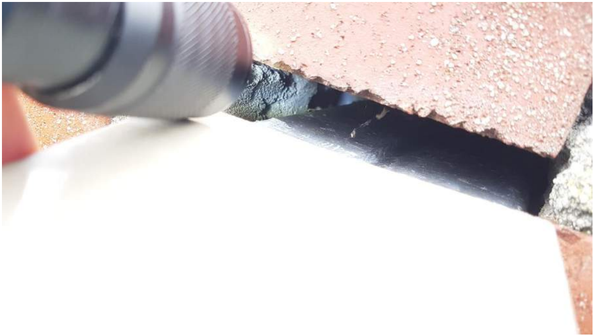
Foto 13: scheur bij de goot naar de spouw toe.
