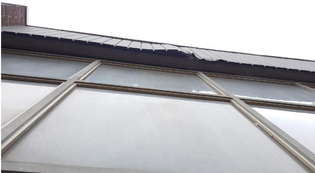
Foto 8: beschadigde beplating op de gevel.
