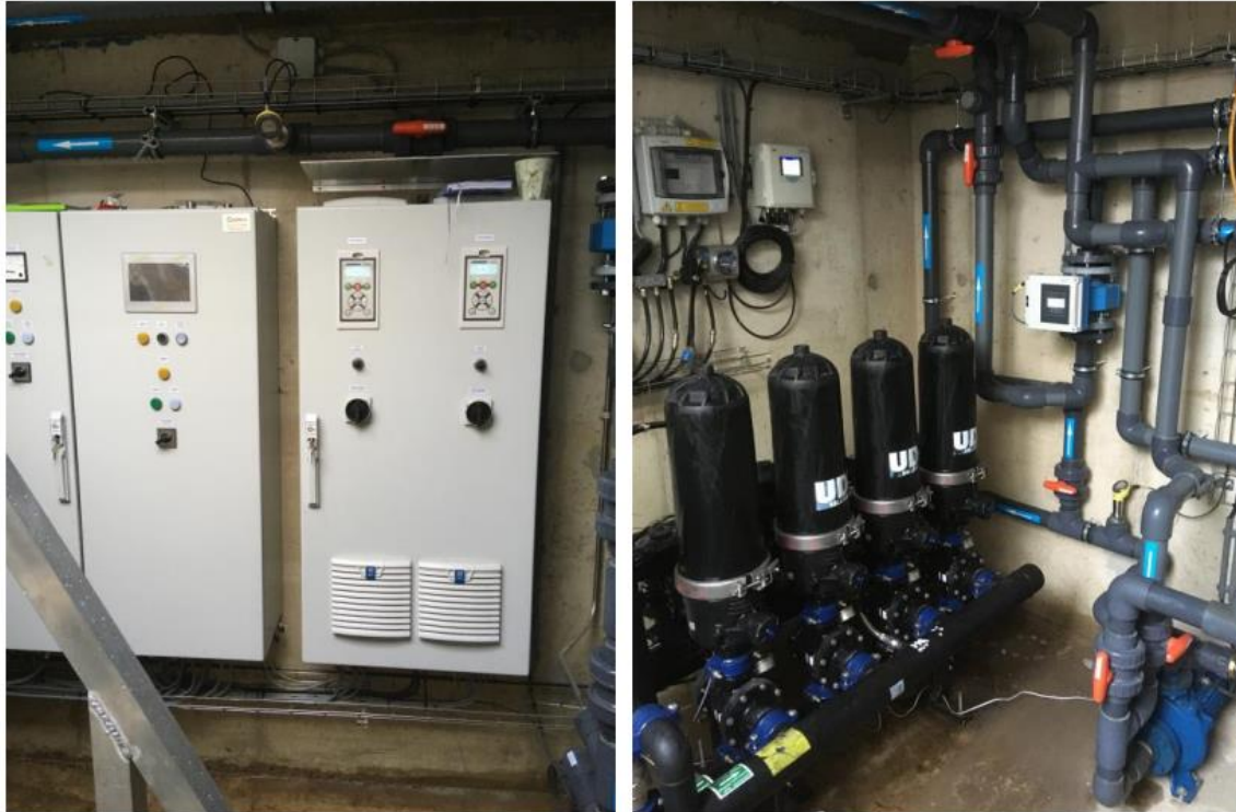
Afbeelding 3 en 4: technische ruimte van het Upflow filter bij Zwemlust
