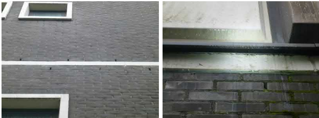
Open stootvoegen in de gemetselde gevels (links) en spleet onder de ramen (rechts).
