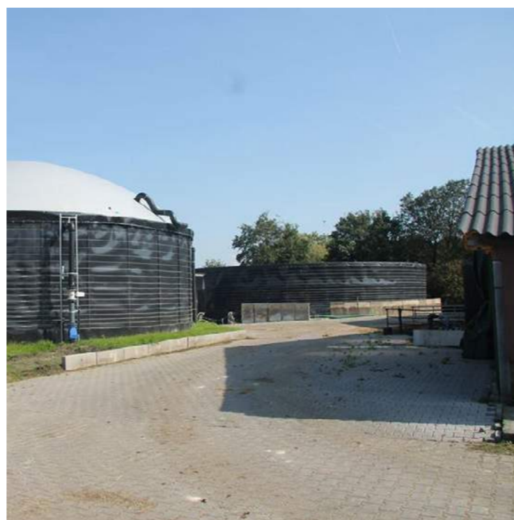
Kleinschalige biogasinstallatie zorgt voor productie van gas voor warmte. Gekoppeld aan bouwblok. Voorwaarden afhankelijk van type landschap. Vereist maatwerk.
