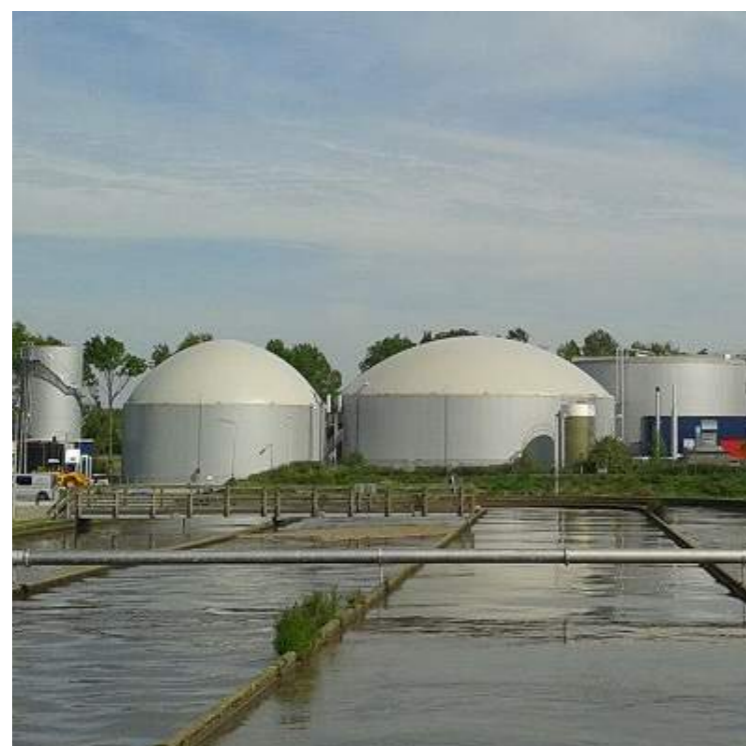
Biogasinstallatie gekoppeld aan RWZI.
