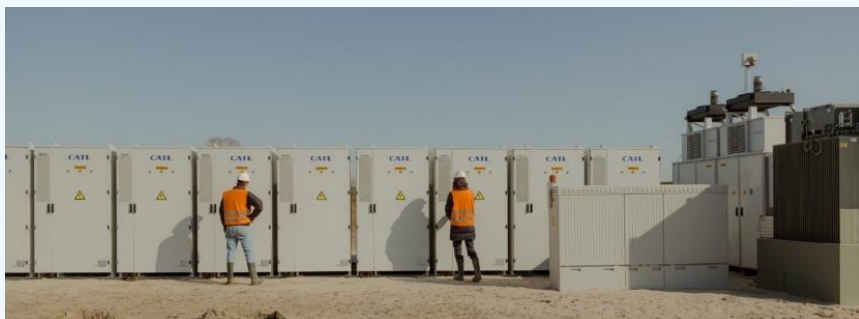
Afbeelding 7. Door Novar gerealiseerde batterij "Bontepolder" in Terneuzen.
